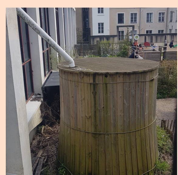
Récupération d'eau pluviale sur un équipement public, Le Papotager, Nantes
