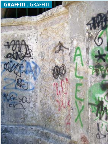
Graffiti in the west abutment of the Aqueduct built in limestone. Graffiti peints sur la butée de l'aqueduc en pierre calcaire.
