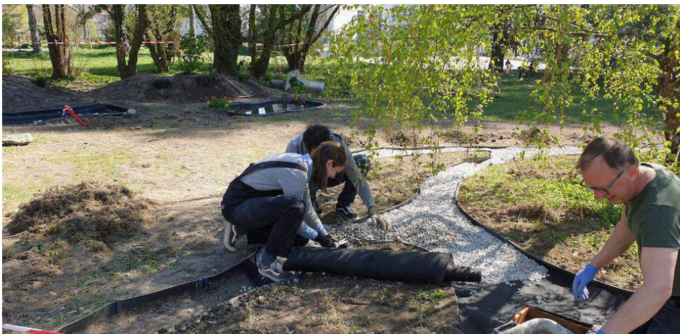
Figure 7. Installation de la zone s'inspirant du jardin sec dans la partie des plantes médicinales (pose de geotextile)
