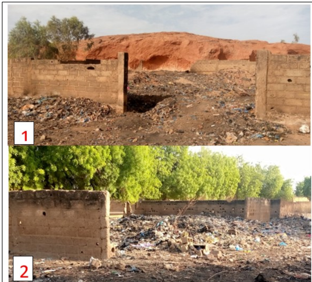
Fig. 4 : Niveau de délabrement avancé des deux sites de transferts du secteur 2 et 7
