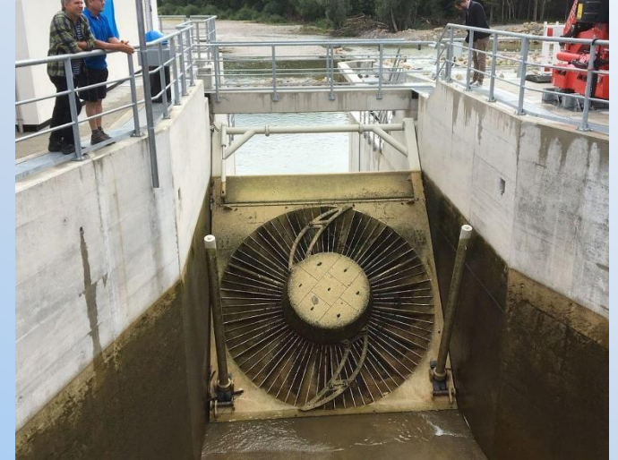
VLH Turbine HPP Baierbrunn Source: Landeskraftwerke Bayern
