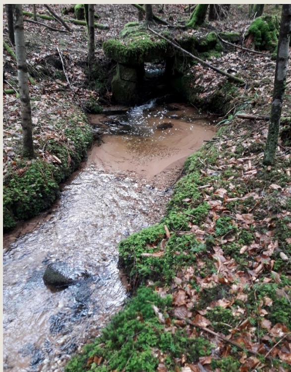
↑ Figure 1. Ensablement visible en sortie de buse, dans la fosse de dissipation d'énergie. Le substrat est complètement bouché par les sédiments fins
