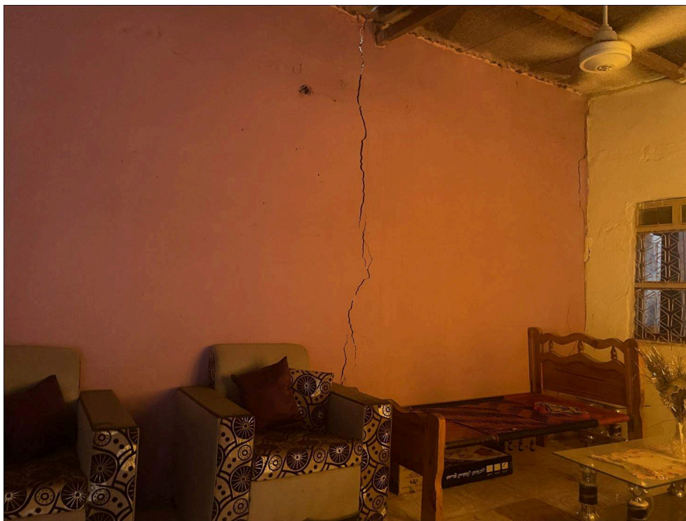
Illustration 7 - Un mur construit en parpaings qui se fissure
