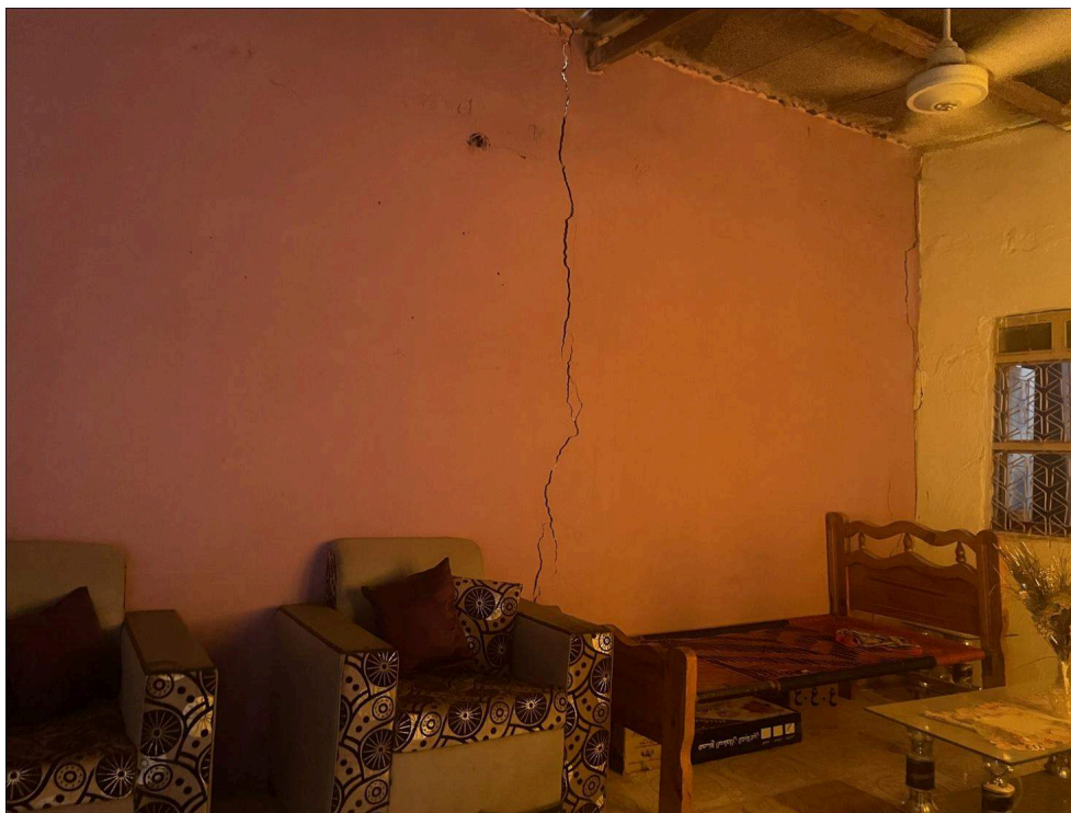
Illustration 7 - Un mur construit en parpaings qui se fissure
