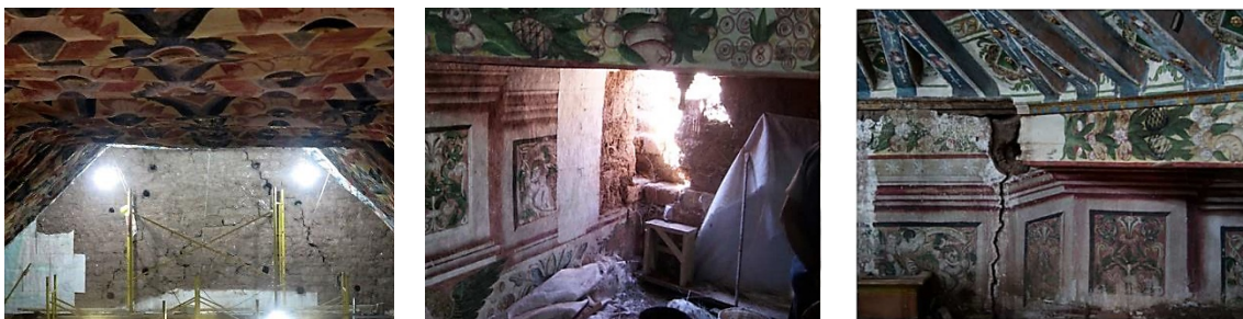
Fig. 2. Anomalías identificadas durante la inspección visual
