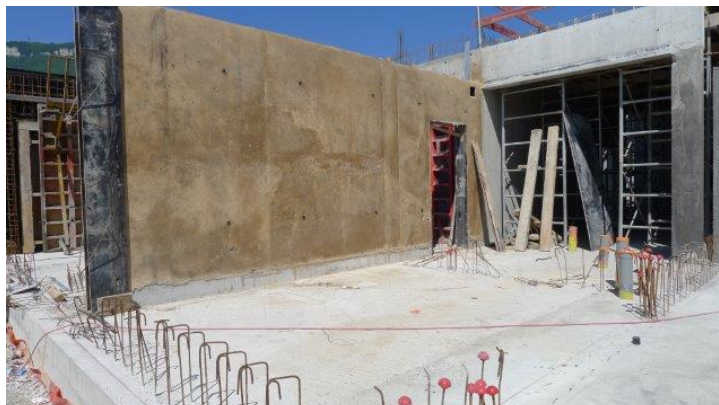
Fig. 09 & 10_ Voile de refend porteur en béton de terre coulée _ chantier CTE ouest à Fontaine (38)
