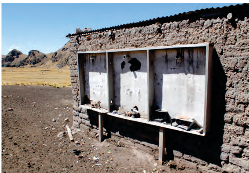
Fig.1 - Muro trombe ejecutado incorrectamente.
