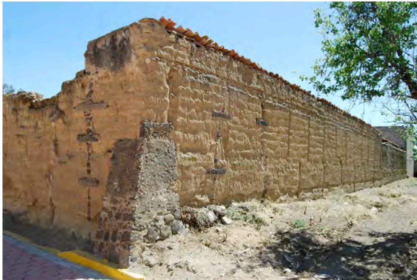
Figura 1. Erosión basal de muros históricos de tapia. Calpan, Puebla. Foto: Luis Guerrero.
