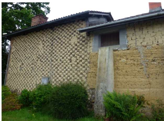
Fig.7 :Coexistence du pisé et du damier dans un même bâtiment, à Peyret-Saint-André (© I. MOULIS)
