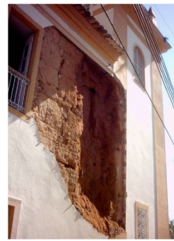
Fig. 2- Area colapsada del muro, fachada Este. Agosto 2005
