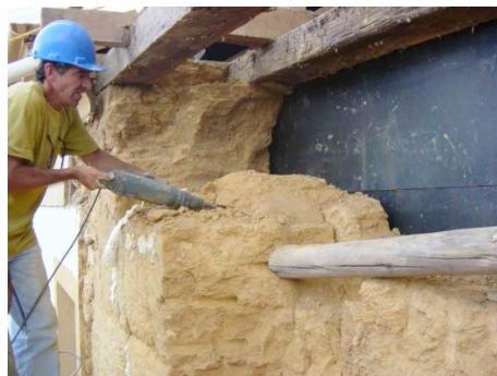
Fig. 3- El proceso de demolición de los bloques de la tapia antigua. Nov. 2005
