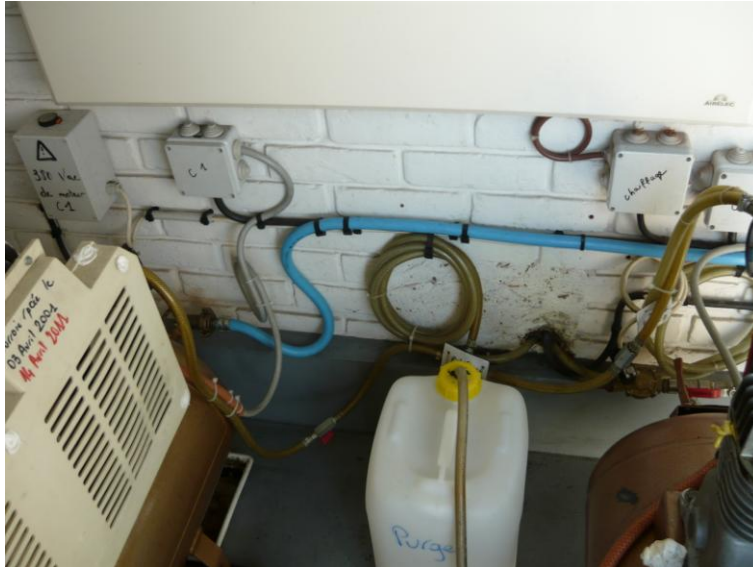
Photo 3. Liaison air et électricité inter-appareils.
