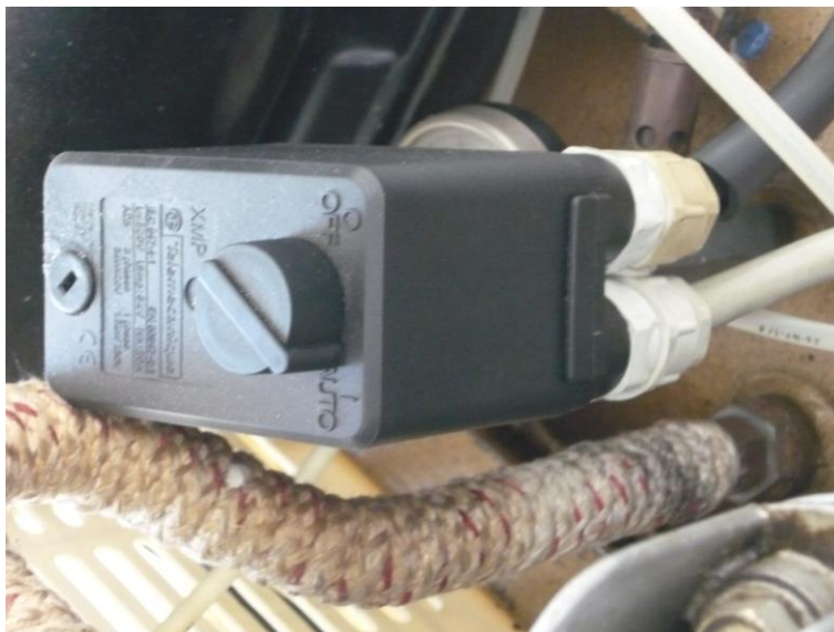
Photo 5. Pressostat de commande en gros plan.
