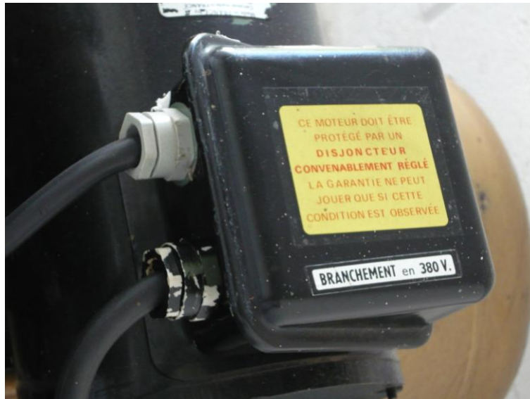
Photo 9. Boîte de connexion du moteur du compresseur 1 de laquelle seront reprises deux phases 400 V de bobine et d'électrovanne.
