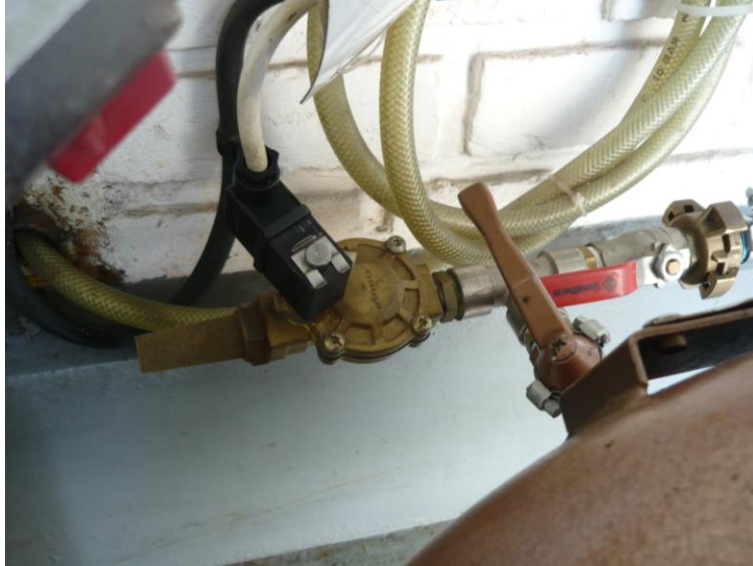
Photo 6. Electrovanne à membrane. En bout d'électrovanne on peut apercevoir son silencieux d'échappement : cône en bronze fritté.
