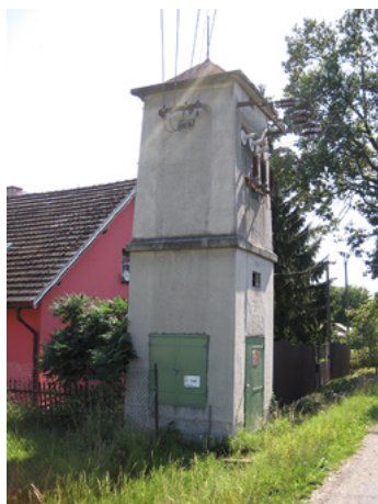
Figure 1. Poste de transformation, Vicence. (© Marcela Efmertová, 2019)
