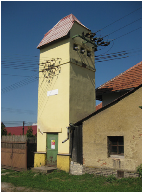
Figure 8. Transformateur relié à une maison, Mutějovice. (© Marcela Efmertová, 2019)
