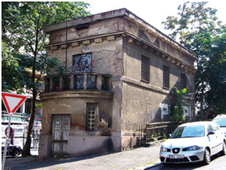
Figure 14 a, b, c. Réhabilitation d'un transformateur dans la galerie, Na Zatlance, Prague 5 - Smíchov. (© Marcela Efmertová, 2020)
