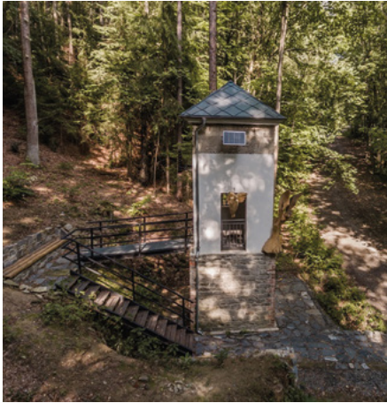
Figure 2. Transformateur décoré de statues d'anges, près de Šumperk. (© Marcela Efmertová, 2019)
