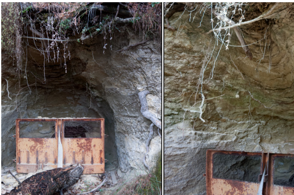
Figure 74 : Photographies de l'abri n°20. (A gauche) Vue générale de l'abri depuis l'entrée. Réinvesti pour l'entreposage de matériel agricole, il n'en reste pas moins instable : la voûte a presque entièrement disparue et laisse apparaître le couvert pédologique sus-jacent. Des dépôts de poussières et de clastes recouvrent les surfaces des objets entreposés, trahissant l'actualité du processus de désagrégation de l'ensemble. (A droite) Vue de la voûte en niches d'arrachement concentriques typiques d'un phénomène de soutirage des plafonds type « fontis ». Élaboration : J. Kemper.
