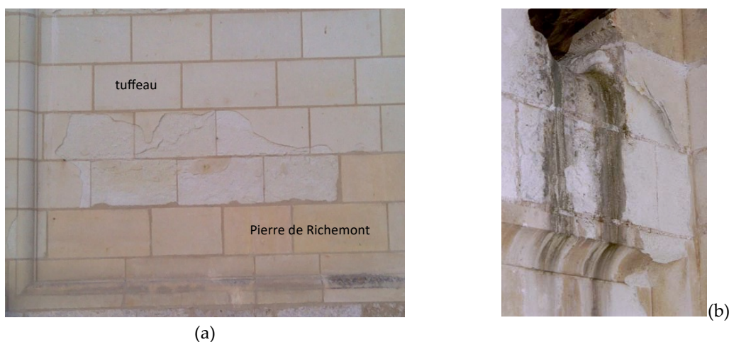
FIGURE 1 (a) Pierres de tuffeau souffrant de desquamation en plaque, à proximité de pierres de Richemont mises en place lors de travaux de restauration (château de Chambord) ; (b) desquamation en plaque sur du tuffeau initié par une arrivée d'eau particulière (château de Chaumont)
