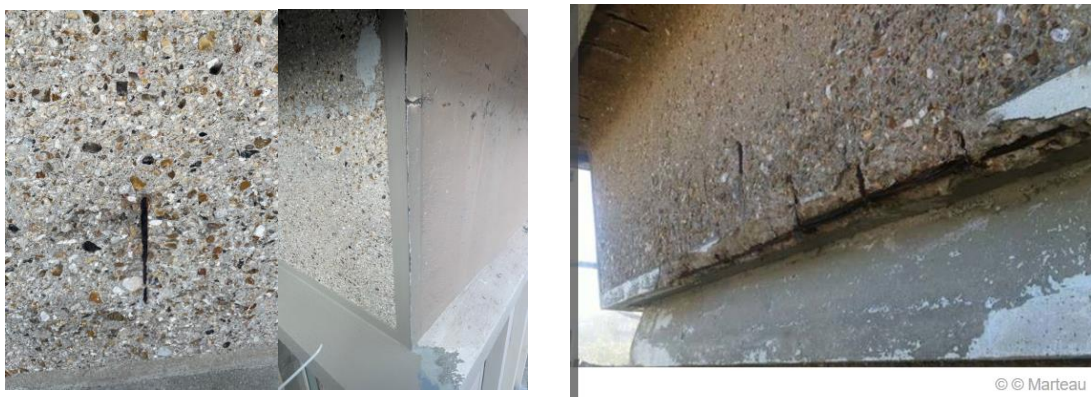
FIGURE 4. Illustrations des pathologies couramment observées : corrosion et patch de ciment gris (dossier la ville du Havre et crédit photo Moniteur -Marteau)
