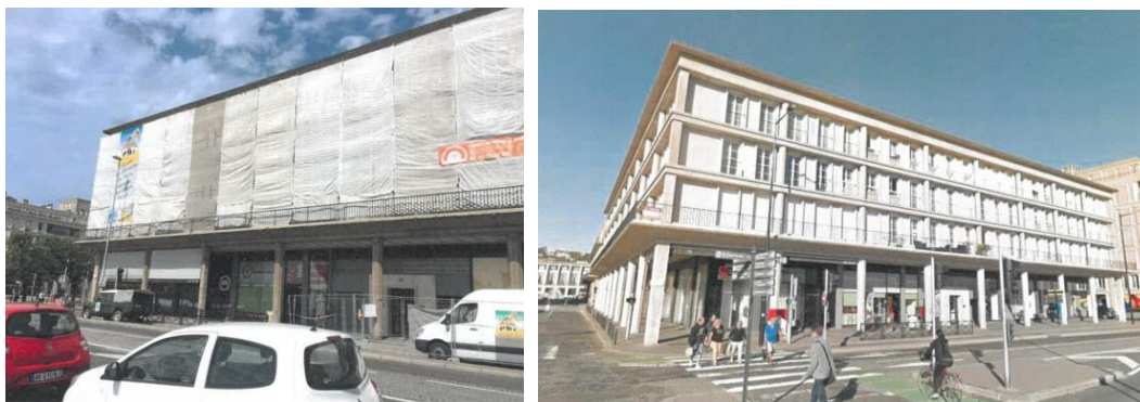
FIGURE 6. Vue d'ensemble de l'îlot V38 en chantier et terminé en 2017 (Photos PBI)
