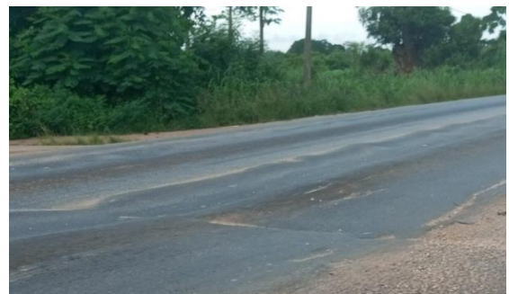
FIGURE 3. Dégradation observée sur l'axe Bopa, Bénin (2022)
