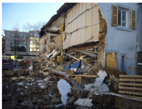
FIGURE 3. Effondrement structurel dû à une rénovation inappropriée [Indekeu, 2023]
