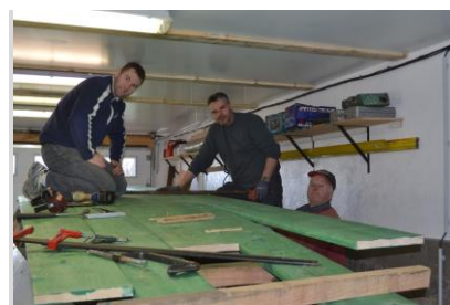
Ill. 3. Stéphane Perrin et Alain Cormier en train de changer la sole du Pierre-Alexandre. © Alain Cormier, Stéphane Perrin, 2014.
