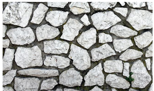
Fig. 33 : Appareil désordonné à joints creux
