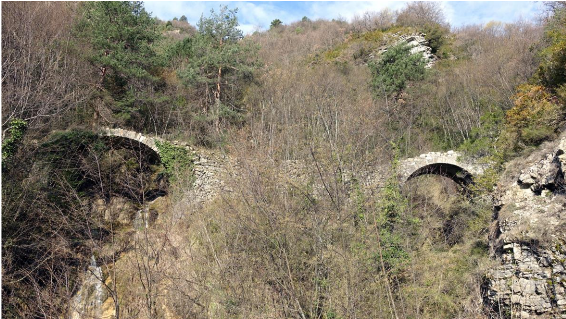
Fig. 5 : Moulinet - Ponts de Cuous : deux ponts successifs à une arche et à tablier horizontal
