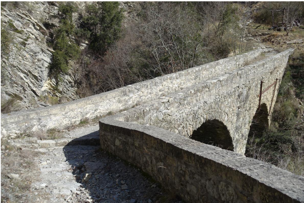
Fig. 6 : La-Tour-sur-Tinée - Pont Saint-Jean : tablier étroit
