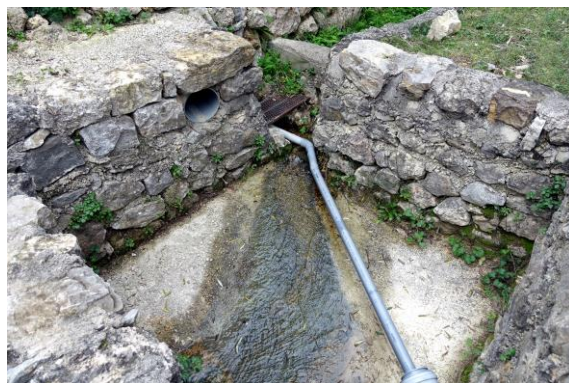
Fig. 19 : Arrivée d'eau de la source au nord de la propriété
