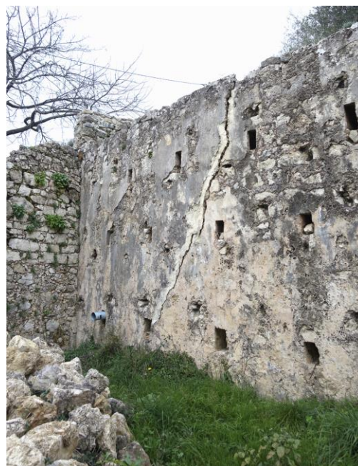
Fig. 35 : Fissure importante (extrémité occidentale)
