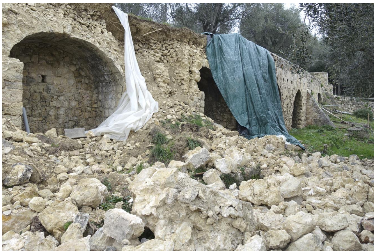
Fig. 39 : Détail de l'effondrement partiel
