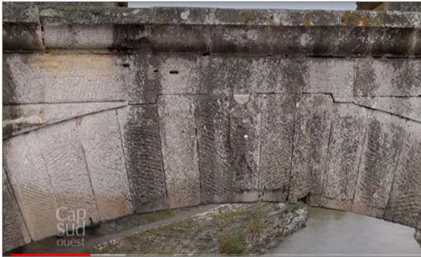
Fig. 22 – Vue de détail de la voûte de l'arche majeure du deuxième étage d'arches du Pont-du-Gard. L'agencement précis et soigné des voussoirs, la finesse des joints, la tenue d'arête et la qualité des adoucis dans les moulures, caractérisent une pierre au grain fin et régulier. Sur la clé, bas-relief représentant sans doute un tailleur de pierre. (Cliché Cap Sud-ouest).
