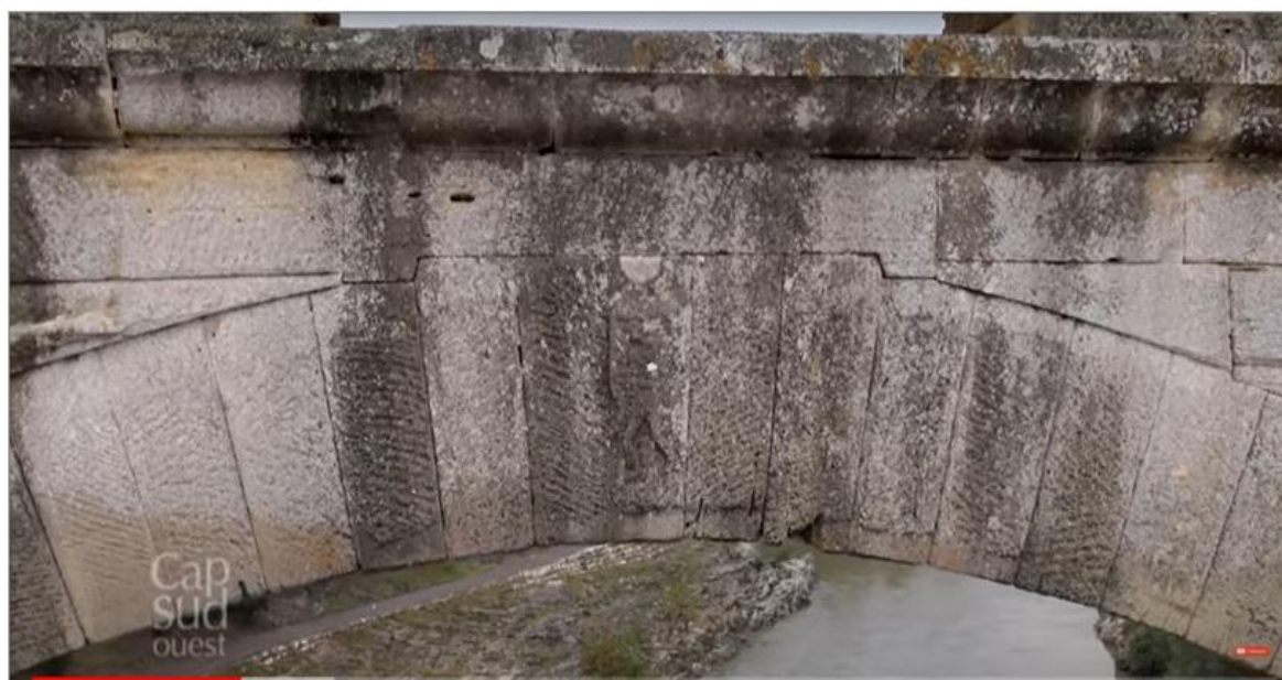
Figure 21 : Vue de détail de la voûte de l'arche majeure du deuxième étage d'arches du Pont-du-Gard. L'agencement précis et soigné des voussoirs, la finesse des joints, la tenue d'arête et la qualité des adoucis dans les moulures, caractérisent une pierre au grain fin et régulier. Sur la clé, bas-relief représentant sans doute un tailleur de pierre. (Cliché Cap Sud-ouest).
