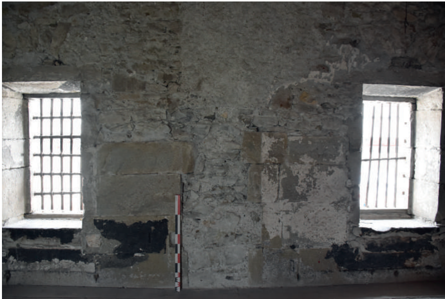
Fig 209 a : Arrachement des maçonneries en ES 1.29 et reparaementage partiel. Clichés : Équipe de fouille 2020.
