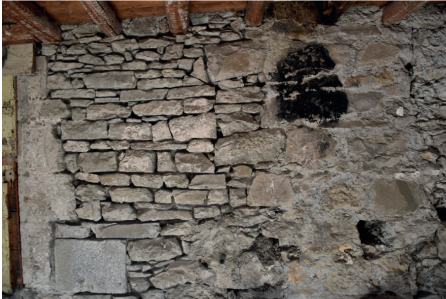
Fig 171 : Vestiges de l'arrachement de la cloison M 1173 dans le mur M 1052. Cliché : Équipe de fouille 2020.
