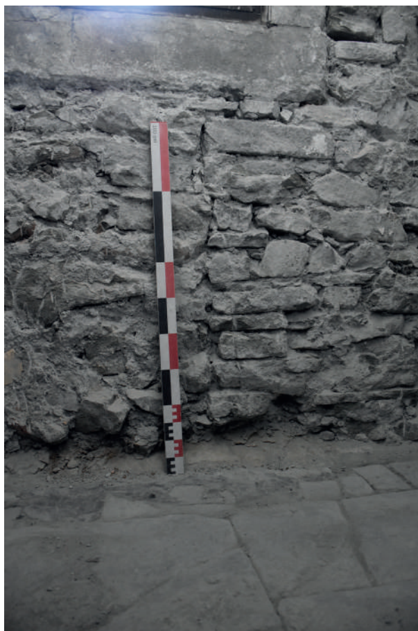
Fig 196 : Reparementage USC 10344 du parement USC 10340 au sein du mur M 1064 (ES 1.11). Cliché : Équipe de fouille 2020.
