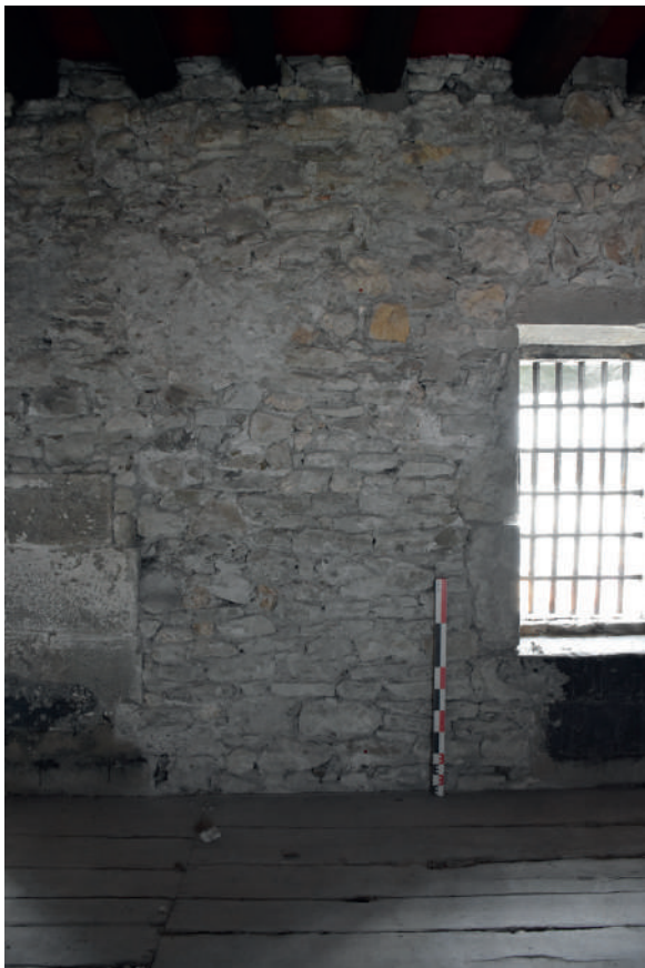
Fig 209 b : Arrachement des maçonneries en ES 1.29 et reparaementage partiel. Clichés : Équipe de fouille 2020.
