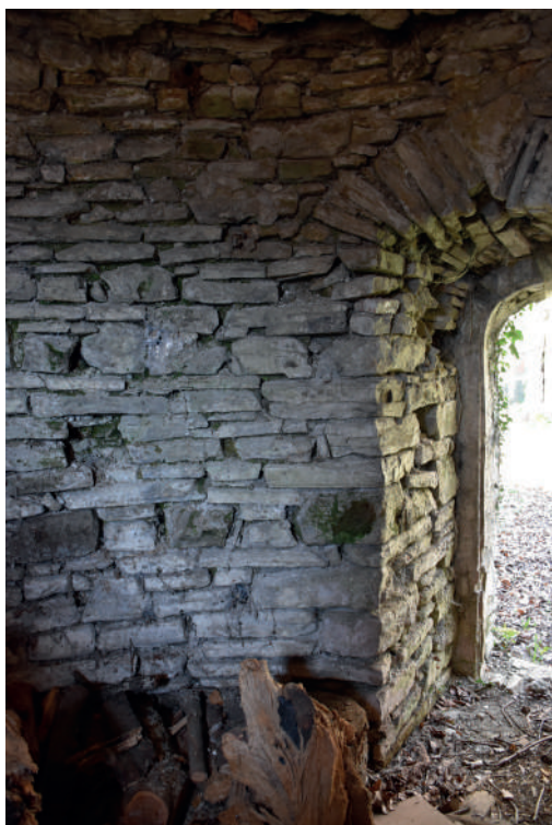
Fig 341 : Appareillage interne de la tour. Cliché : Equipe de fouille.
