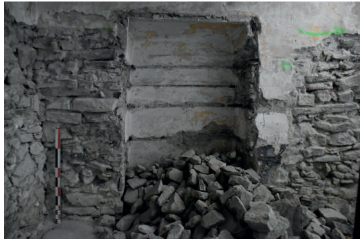
Fig 162 : Placard PLC 1109. Cliché : Équipe de fouille 2020.
