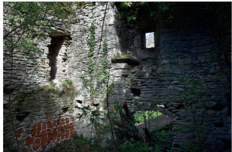
Fig 377 : Ouverture récente dans le mur gouttereau ouest et baie à coussiège. Cliché : Equipe de fouille.
