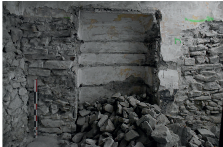
Fig 162 : Placard PLC 1109. Cliché : Équipe de fouille 2020.
