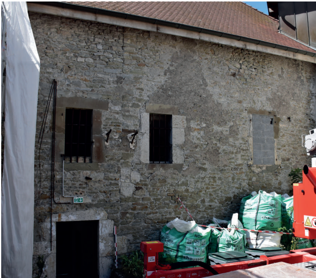
Fig 165 : Parement extérieur de l'agrandissement du bâtiment ouest des prisons. Présence d'un coup de sabre sur toute la hauteur du bâtiment. Cliché : Équipe de fouille 2020.
