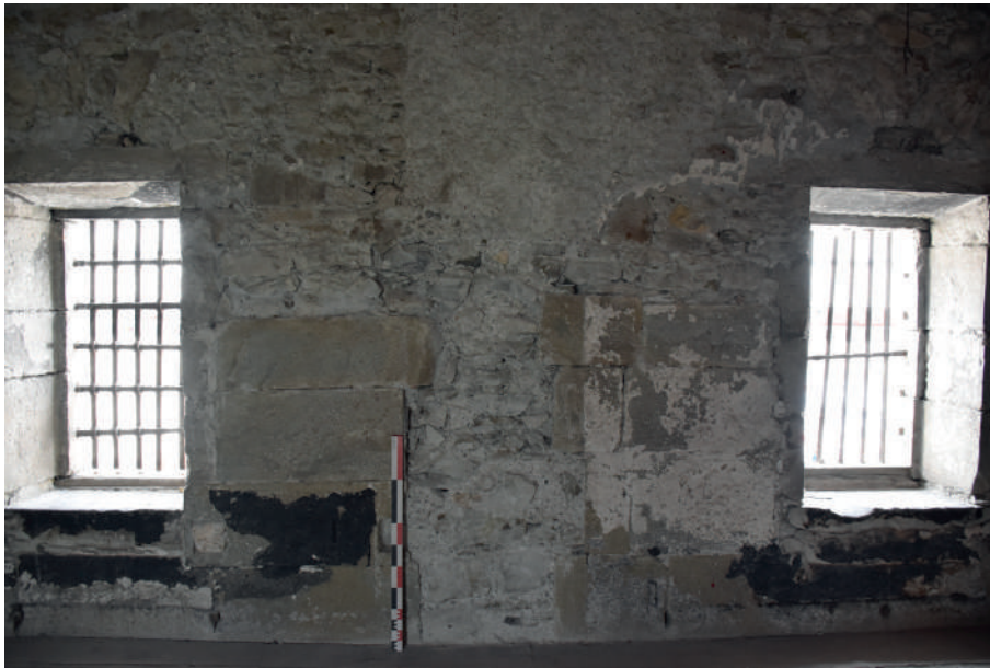
Fig 209 a : Arrachement des maçonneries en ES 1.29 et reparementage partiel. Clichés : Équipe de fouille 2020.
