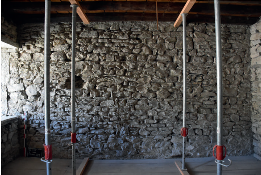
Fig 230 a et b : Présence de trous de boulin au sein du mur M 1143. Clichés : Équipe de fouille 2020.
