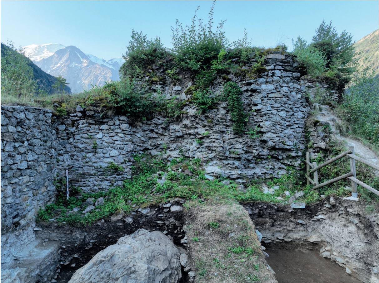
Fig. 25 : Parement écroulé de la tour maîtresse à l'intérieur du logis. Crédit : Equipe de fouille.
