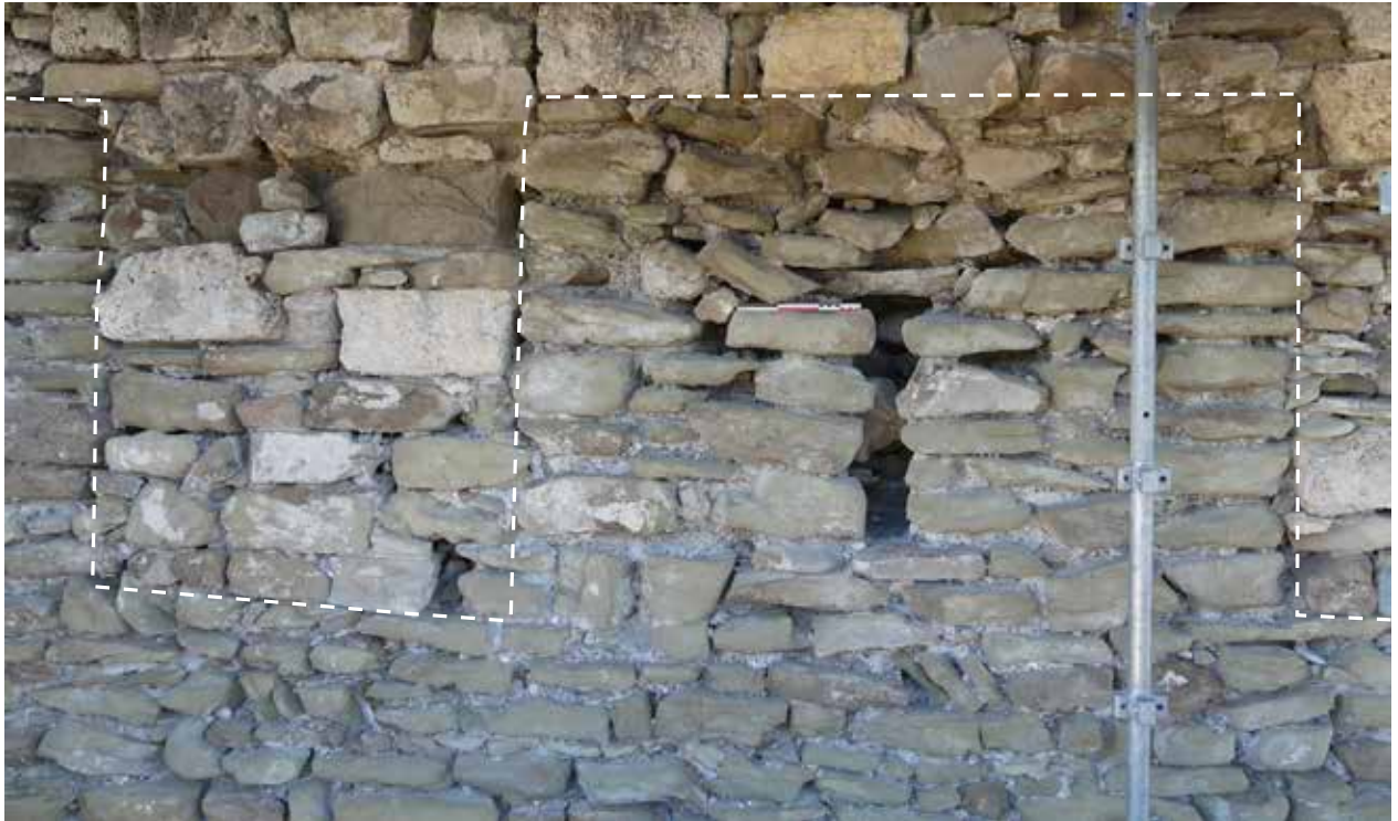
Fig. 6 : Portion du crénelage de la partie centrale de la courtine sud (2020) © S. Bocquet - Inrap.
