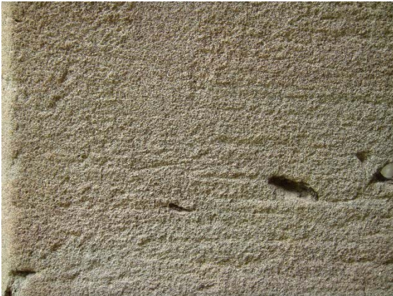
Fig. 6 – Aspect d'une pierre de molasse, abbaye du Lieu, Haute-Savoie.
