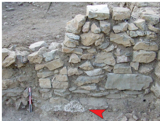
■ 98 La partie sud du mur MR801052, avec restes d'enduit à sa base (parement ouest) [flèche] (A. Beylier).
