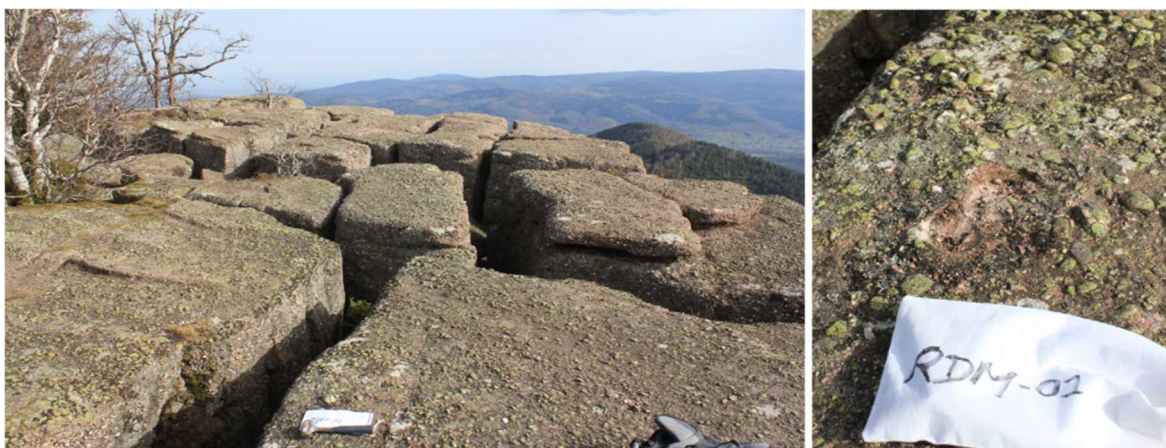
Fig. 6 : A gauche : Vue depuis le Rocher de Mutzig, sommet rocheux fortement altéré et fracturé. A droite : exemple d'échantillonnage et mise en évidence de l'érosion de la surface.
