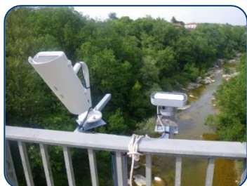
Figure 1 : Station de l'Auzon – Montage des capteurs sur potence articulée, ici basculée pour maintenance
