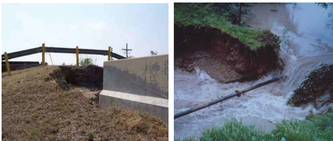
FIGURE 7. Brèche à la transition entre des tronçons de digue en remblai et en béton armé [6] ; Brèche dans une digue, au droit d'une conduite traversante sur le Rhône (Source : SNRS).
