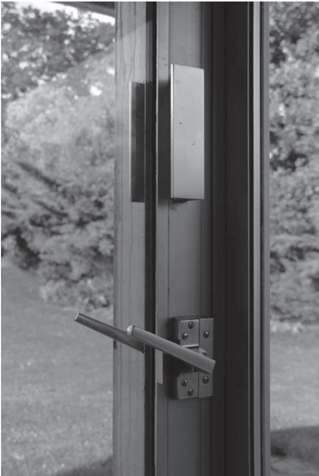
Fig. 3 : Maison Delcourt, commande d'une baie coulissante de la façade sud. Photo Richard Klein, 2018.
