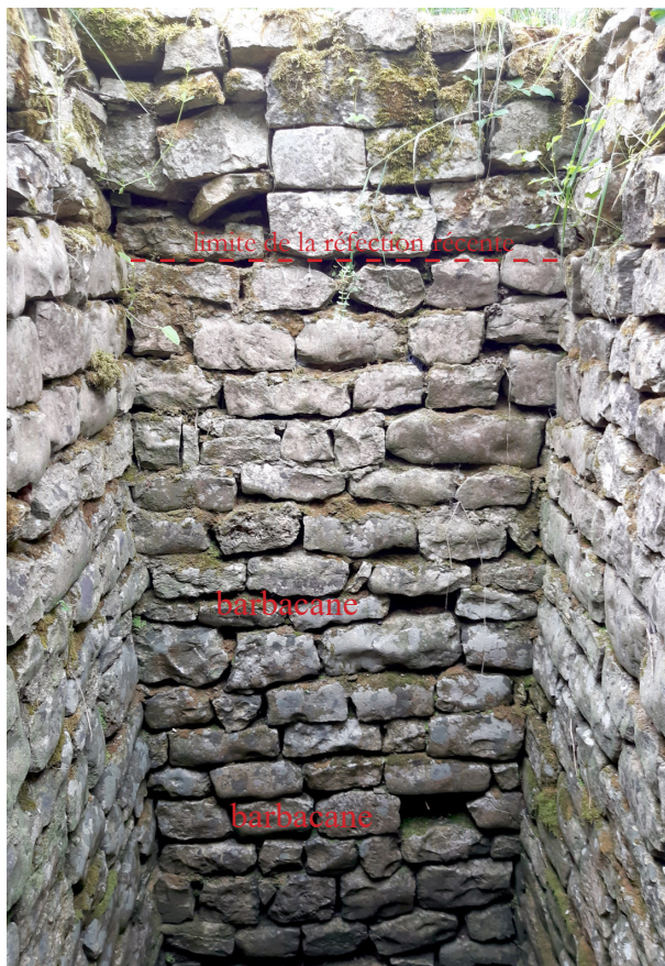
Fig. 28. L'intérieur du fait F3 : noter l'usure de la surface des blocs, les 4 niveaux du haut sont récents, le contraste est bien visible. - Cl. E. Yény.
