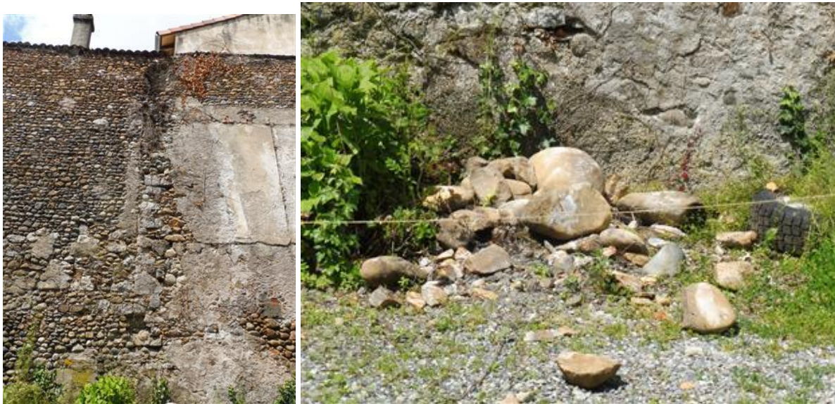
Figure 2. 22 – Chutes d'éléments de maçonnerie sur un mur de propriété (photos M.P. Arrieu 2023)
