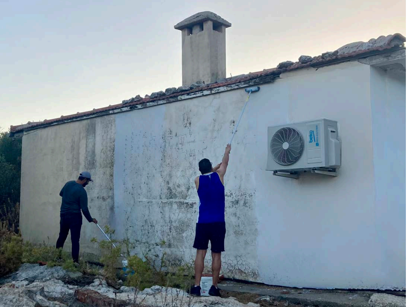
PAAM altyapı ve üstyapı çalışmaları. Fotoğraf: Asil Yaman / PAAM infrastructure and superstructure work. Photo: Asil Yaman
