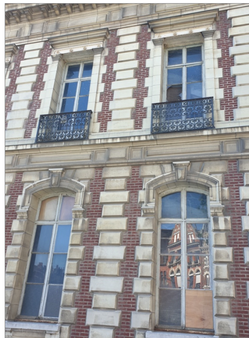
Photo 7 – La gare de Roubaix (façade Nord-Est) en attente d'une réhabilitation (cliché M-A. Lanneaux, mai 2021)
