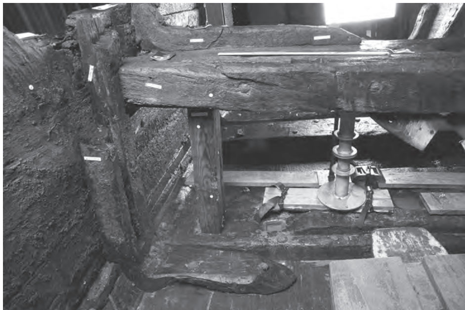
Fig. 168 : Vue de la réparation de la fissure effectuée sur l'arrière du banc de mât, sur bâbord, au moyen de clous transversaux et d'une épontille de soutien (L. Roux, O'Can-Ipso Facto , MdAa/CG13).
