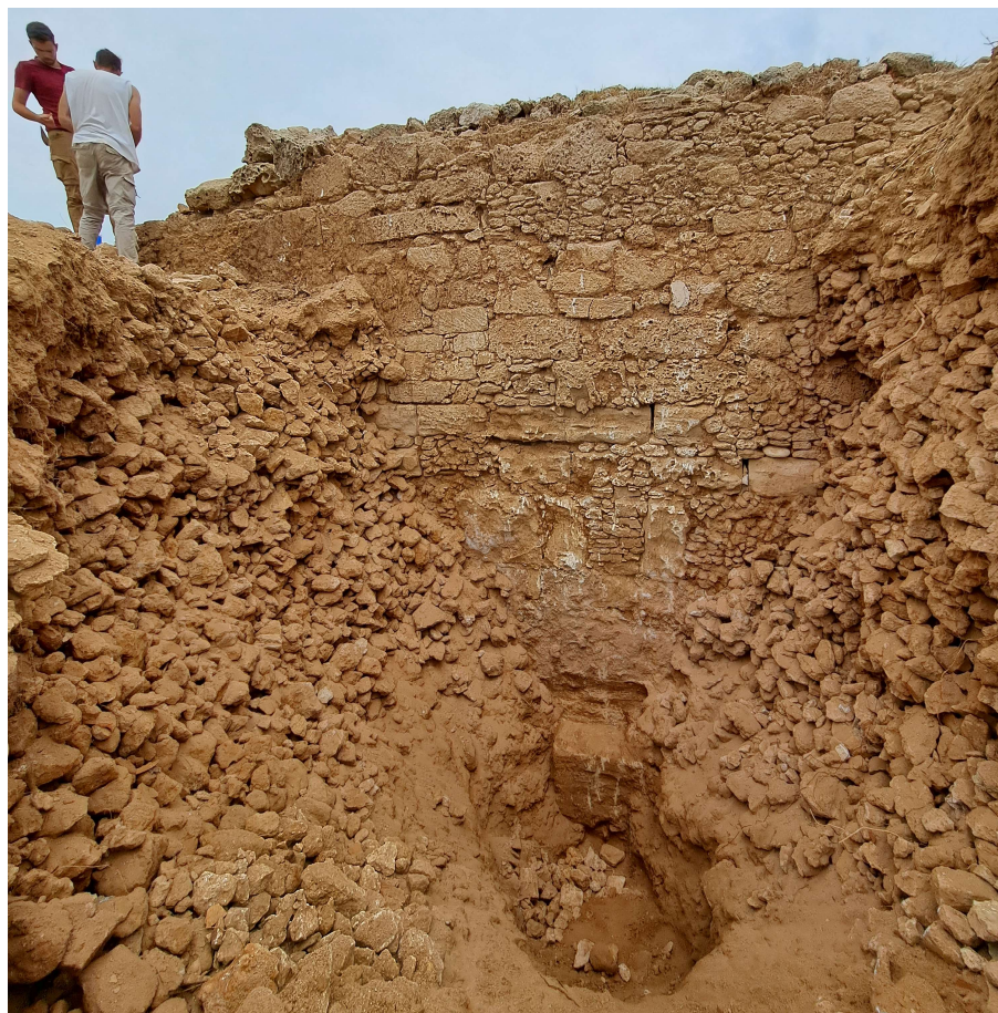
Fig. 27. Le mur fondé sur la roche marine a une élévation conservée sur plus de 5 m de hauteur. Vue vers l'Est avant de reboucher. Cliché : Ma/af/C. Balandier.
