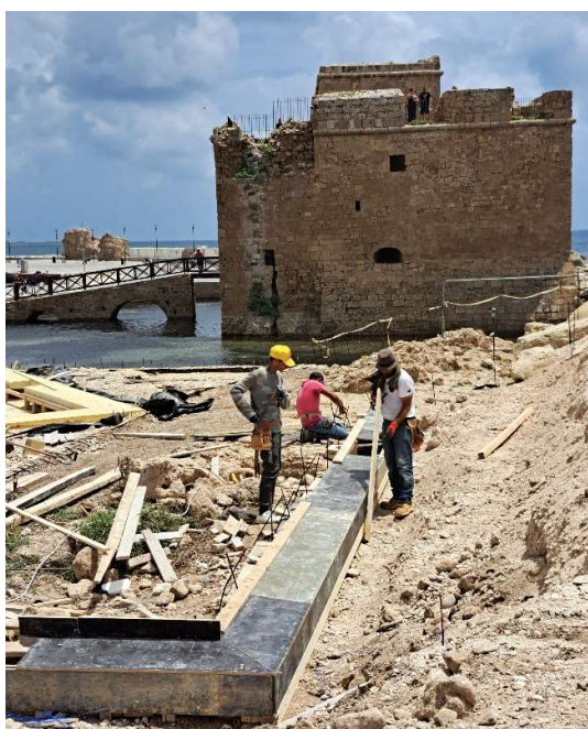
Fig. 71. Le coffrage en cours de construction sur le tracé du rempart. Vue vers l'Est. Cliché : MafaP/C. Balandier.
