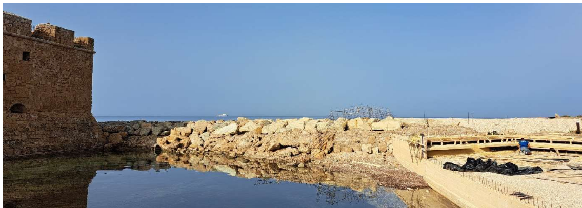
Fig. 67. Les vestiges de l'assise de blocs de boutisses sous les blocs du brise-lame moderne et la plateforme en construction à droite. Vue vers le Sud. Cliché : Mafap/C. Balandier
