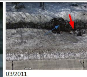
03/2011 Déformation en élévation (flèche rouge). Écoulement visible (filet d'eau signalé par la flèche bleue).
