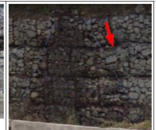
10/2011 Déformation en élévation (flèche rouge). Limite d'écoulement de l'eau sur le parement (pointillés bleus).
