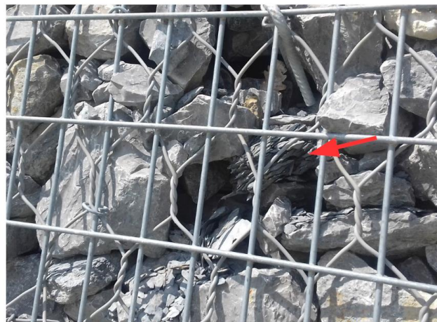
Photographie 1 : Délitement d'une pierre de remplissage des gabions et « écoulement » des éléments résiduels
