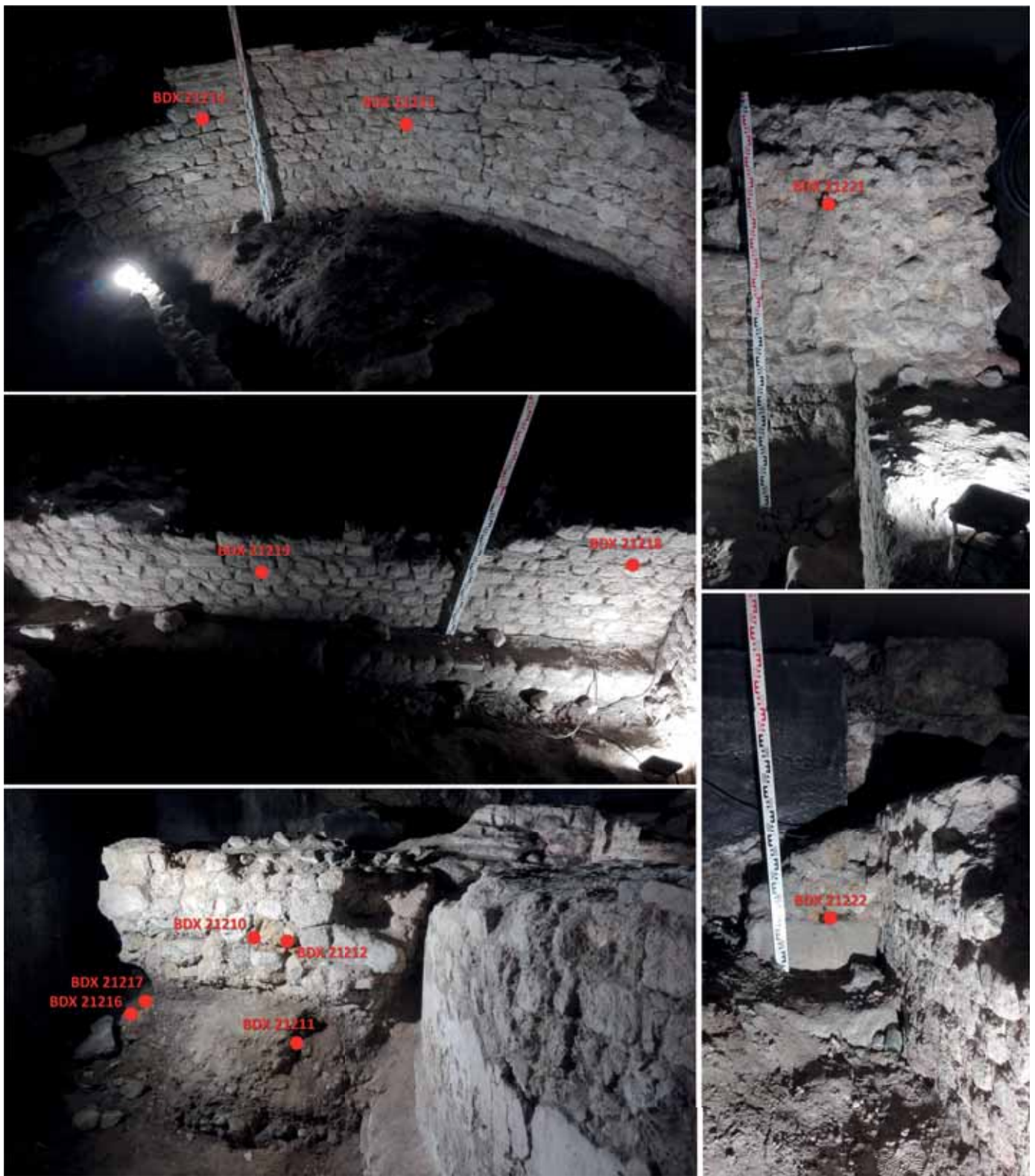
Fig. 9 Localisation des prélèvements des mortiers datés par luminescence optiquement stimulée (technique de single grain). a. Abside, vue de l'intérieur ; b. Mur nord-sud, vue de l'intérieur ; c. Contrefort sud-est (à gauche) soutenant l'abside (à droite), remblai et restes des murs de l'habitat antique ; d. Maçonnerie médiévale ; e. « Pilastre » en remploi (à gauche) et mur nord-sud (à droite).
