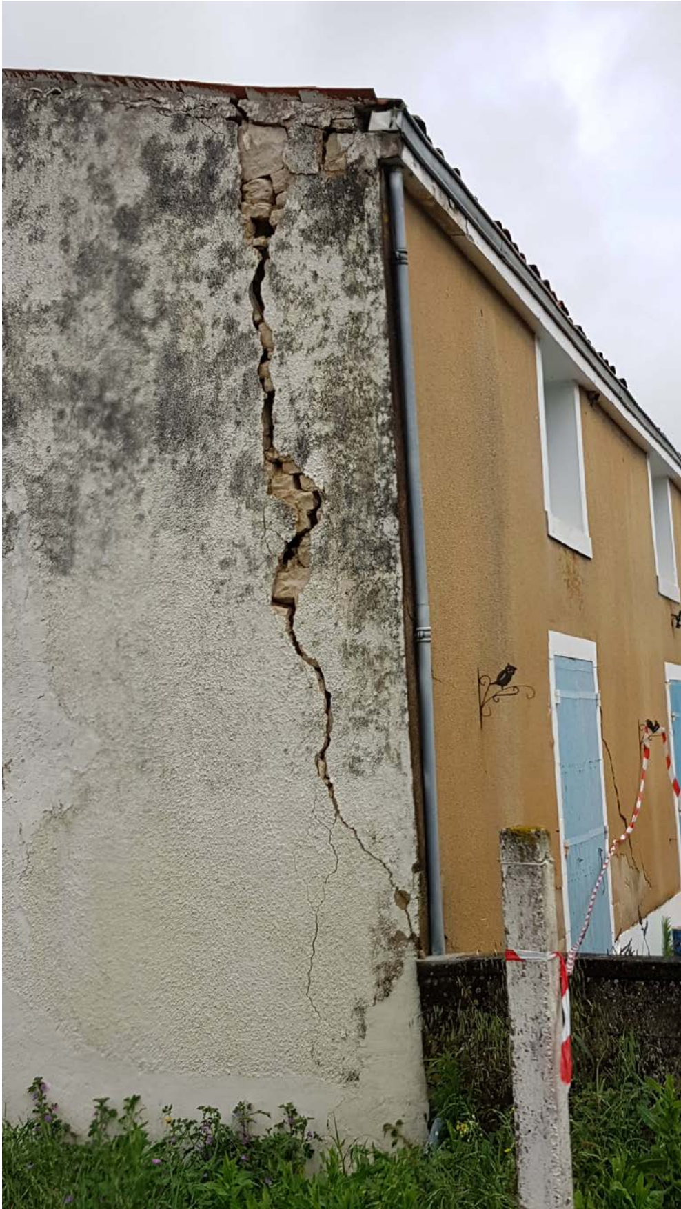
Figure 2-30 : Fissuration de déversement sur un mur de façade en maçonnerie de pierres, dommage de degré 3, (commune de Cram-Chaban).
