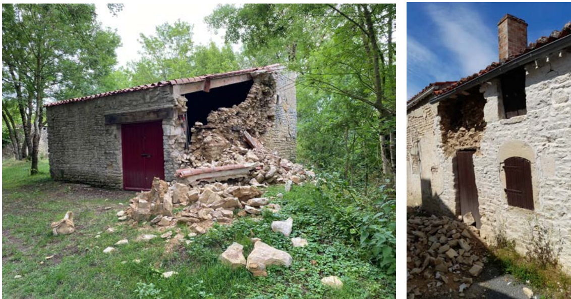
Figure 2-18 : Exemples de dommages de degré 4, ouvertures hors plan de murs porteurs sur des bâtiments en maçonnerie de pierres (commune de La Laigne).
