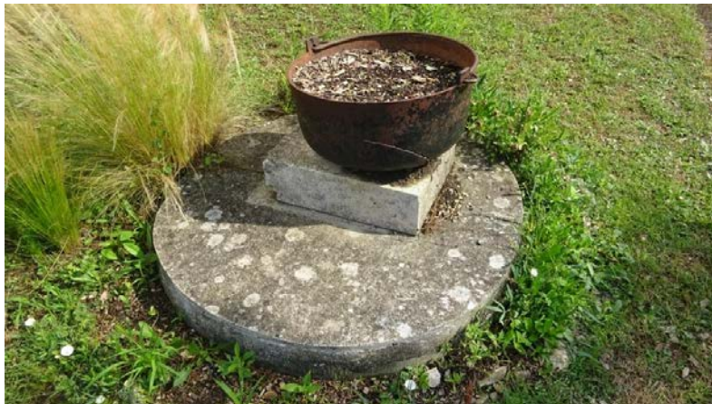
Figure 2-8 : Déplacement de plusieurs centimètres d'une dalle en béton et d'un vase en métal sur une plaque de collecteur des eaux usées (commune de La Laigne).
