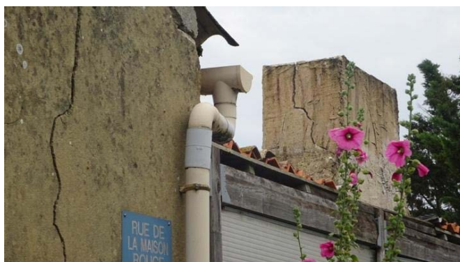
Figure 2-24 : Exemple d'endommagement de cheminée (commune de Cram-Chaban)
