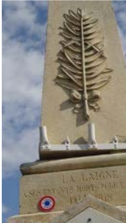
Figure 2-7 : Déplacement de la partie supérieure du monument aux morts par mouvement de rotation (commune de La Laigne).
