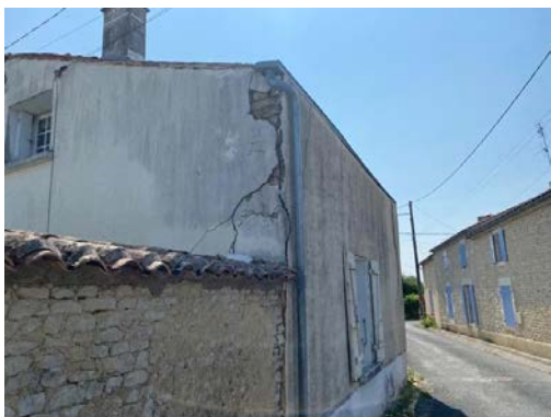
Figure 2-09 : Exemple d'endommagement de degré 3 sur maçonnerie de pierres (commune de La Laigne).
