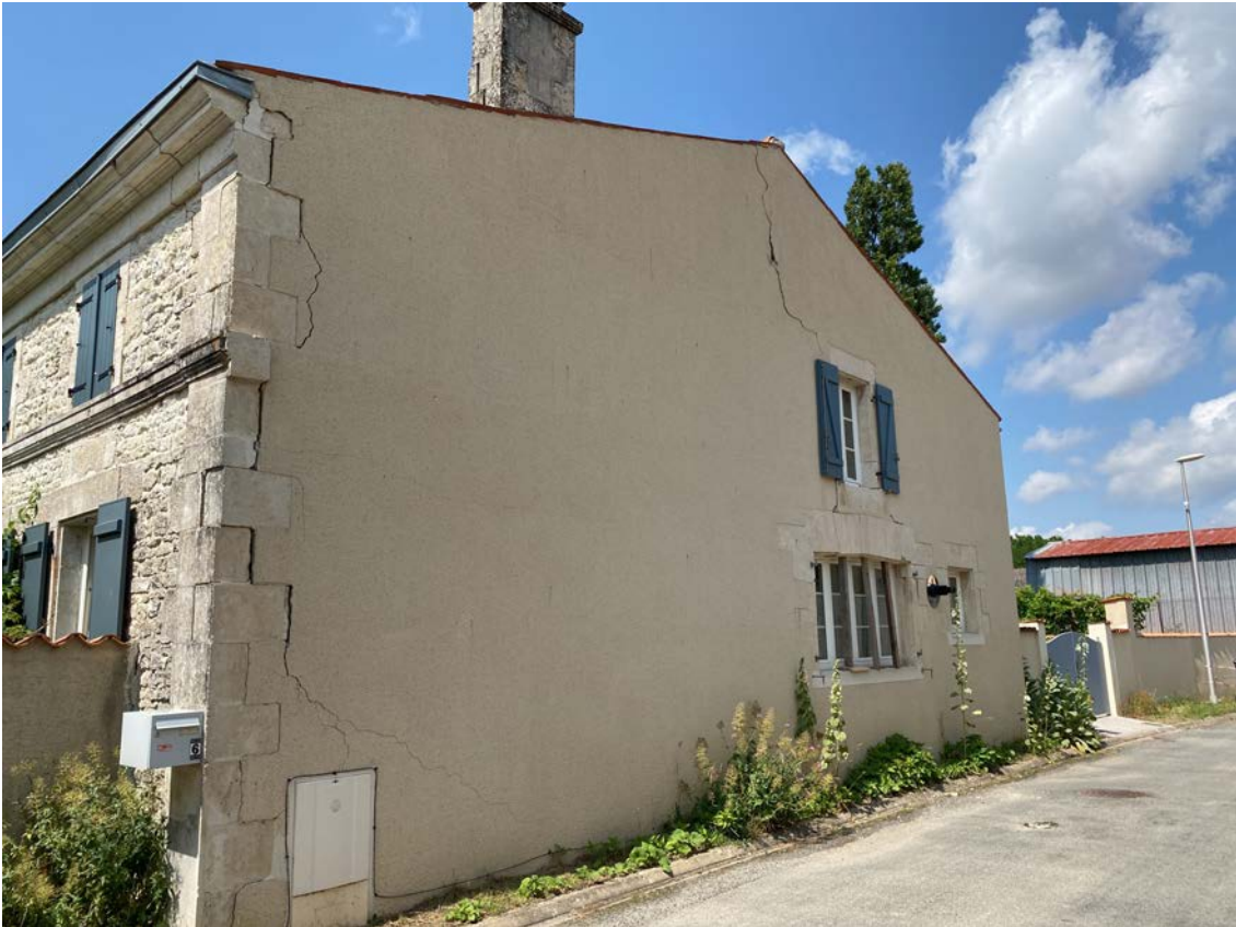
Figure 2-32 : Fissuration le long du harpage d'angle en maçonnerie de pierres massives sur un bâtiment en maçonnerie de pierres, dommage de degré 3 (commune de Cram-Chaban – lieu dit Le Peu).
