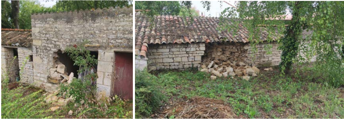
Figure2-17 : Exemple de dommages de degré 4, ouvertures hors plan de murs porteurs sur des bâtiments en maçonnerie de pierres, vues des façades opposées (commune de La Laigne).
