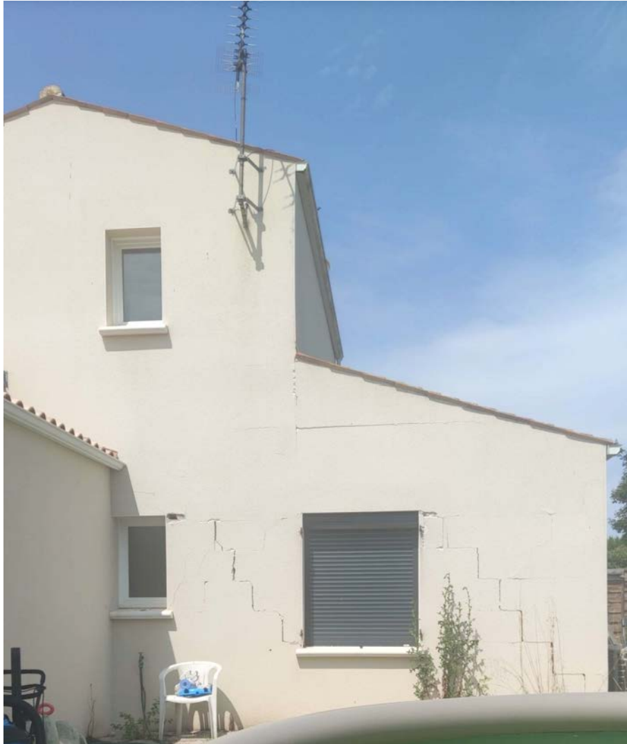
Figure 2-19 : Endommagement de degré 3, fissuration entre les éléments préfabriqués de béton (agglos), (lotissement récent de la commune de La Laigne).
