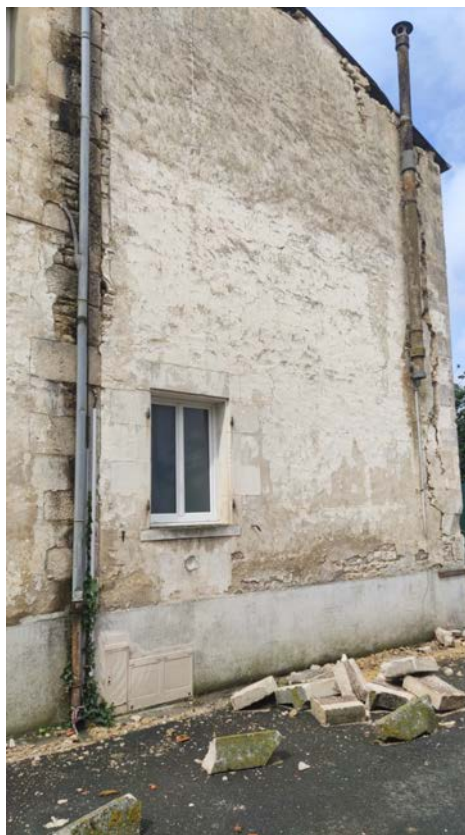
Figure 2-35 : Endommagement hors plan au droit des fermes de toitures et fissuration de déversement à l'angle du bâtiment, dommage de degré 3, interaction possible entre deux corps de bâtiments (commune de Cram-Chaban).
