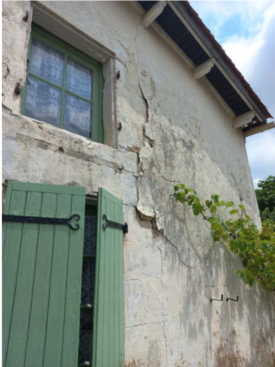
Figure 2-33 : Fissuration de façade et début de poussée sur l'appareillage du mur en pierres brutes au droit de pierres taillées plus massives, dommage de degré 3 (commune de Cram-Chaban).
