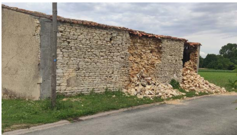
Figure 2-22 : Dommages de degré 4, dislocation hors plan d'un mur porteur sur un bâtiment en maçonnerie de pierres (commune de La Laigne, lieu-dit Crépé)
