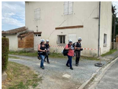
Figure 2-10 : Fissuration diagonale, endommagement de degré 2 et équipe d'experts du GIM (commune de La Laigne).
