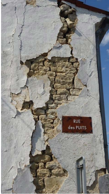
Figure 2-14 : Dommages de degré 3, fissuration large et début de poussée hors plan d'éléments de maçonneries de pierres (commune de La Laigne).
