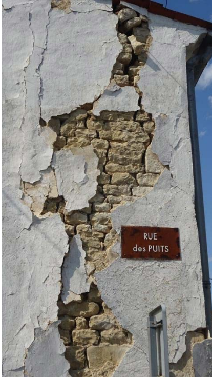
Figure 2-14 : Dommages de degré 3, fissuration large et début de poussée hors plan d'éléments de maçonneries de pierres (commune de La Laigne).
