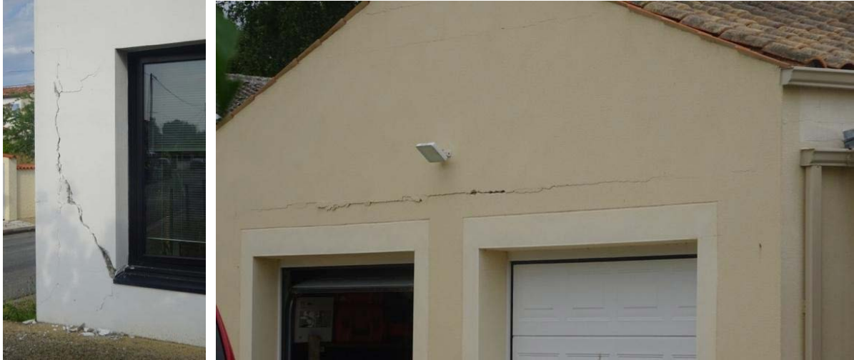
Figure 2-11 : Dommages de degré 2, fissuration d'éléments de maçonneries de béton (commune de La Laigne).
