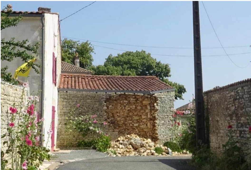
Figure 2-16 : Dommages de degré 4, défaillance sérieuse d'un mur en maçonnerie de pierres (commune de La Laigne).
