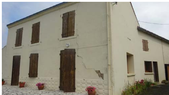
Figure 2-25 : Endommagements de degré 2, fissuration diagonale sur maçonnerie de pierres (commune de Cram-Chaban)
