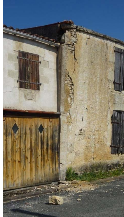
Figure 2-15 : Dommages de degré 3, fissuration large en angle de bâtiment et poussée hors plan d'éléments de maçonneries de pierres, interaction entre deux bâtiments (commune de La Laigne).
