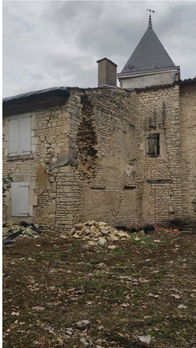
Figure 2-21 : Dommage de degré 4, dislocation hors plan du parement en pierres taillées d'un bâtiment en maçonnerie de pierres, irrégulier en plan, perte de continuité de la maçonnerie et endommagement des fermes de toitures (commune de La Laigne, lieu-dit BeauLieu)
