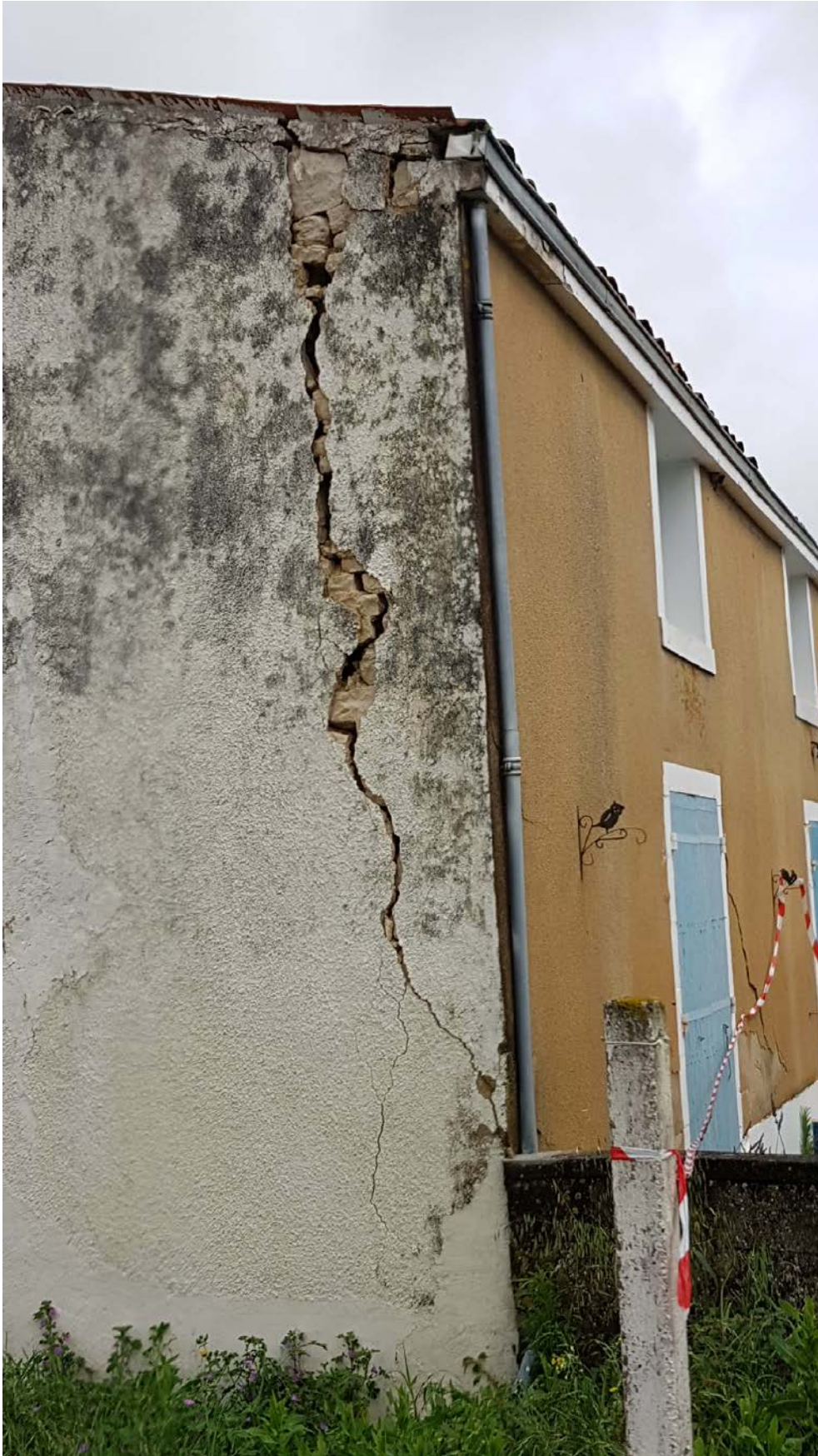
Figure 2-30 : Fissuration de déversement sur un mur de façade en maçonnerie de pierres, dommage de degré 3, (commune de Cram-Chaban).
