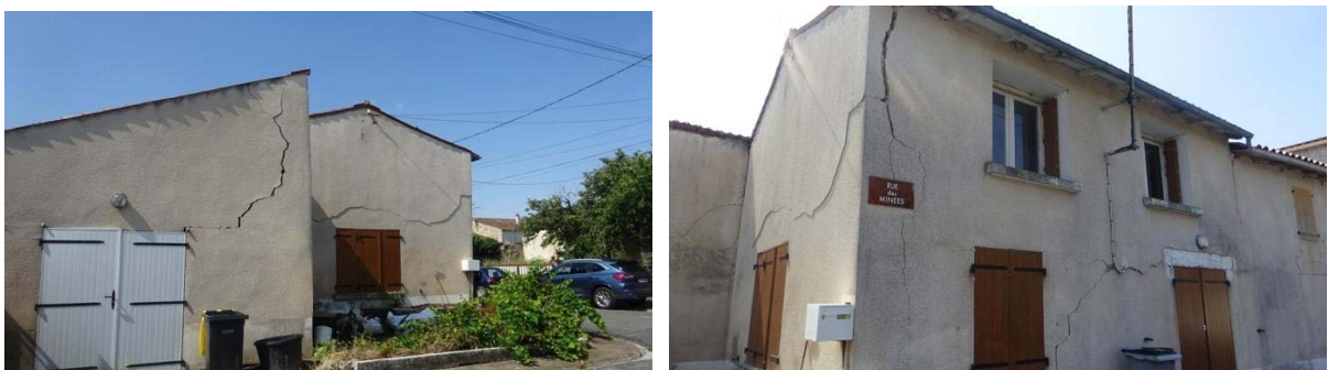
Figure 2-13 : Dommages de degré 4, fissuration larges et profondes dans la plupart des murs, perte de continuité de la maçonnerie (commune de La Laigne)
