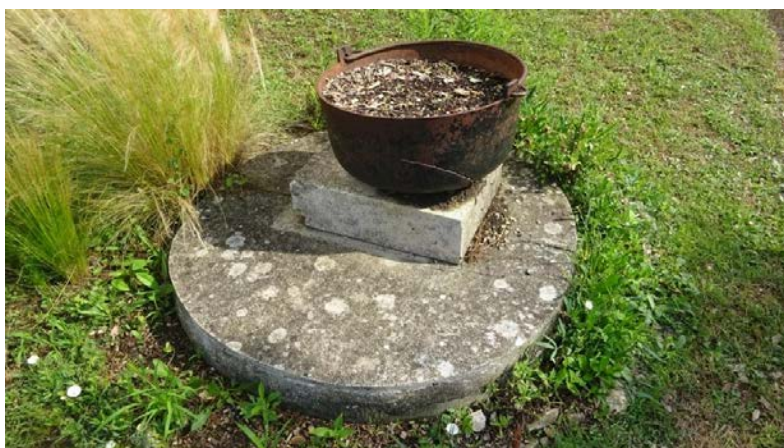
Figure 2-8 : Déplacement de plusieurs centimètres d'une dalle en béton et d'un vase en métal sur une plaque de collecteur des eaux usées (commune de La Laigne).
