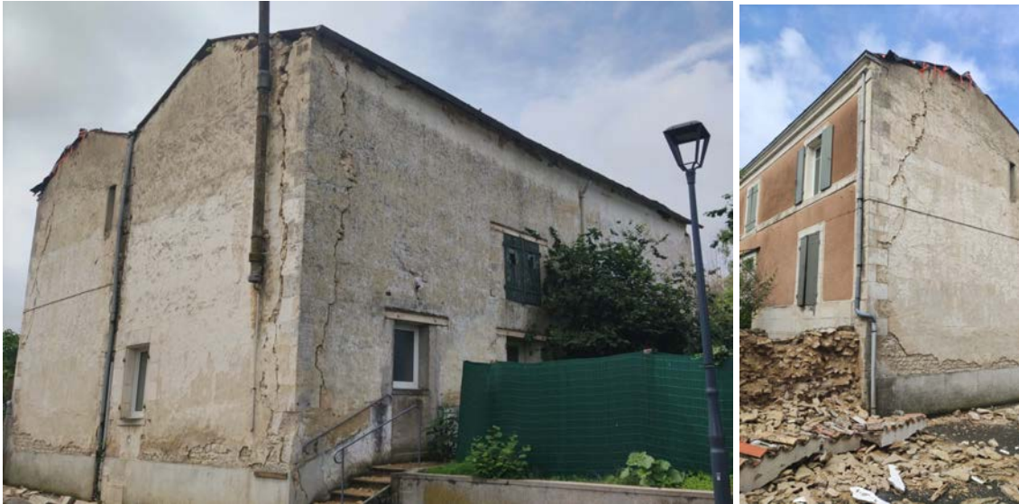
Figure 2-31 : Fissures de déversement le long des harpages d'angle en pierres massives sur un bâtiment en maçonnerie de pierres et endommagement des fermes de toiture (vues des 2 pignons, photo droite et gauche), dommage de degré 3 ; ainsi que l'effondrement d'un mur de propriété en maçonnerie de pierres tout venant (photo de droite - hors utilisation EMS-98), (commune de Cram-Chaban).
