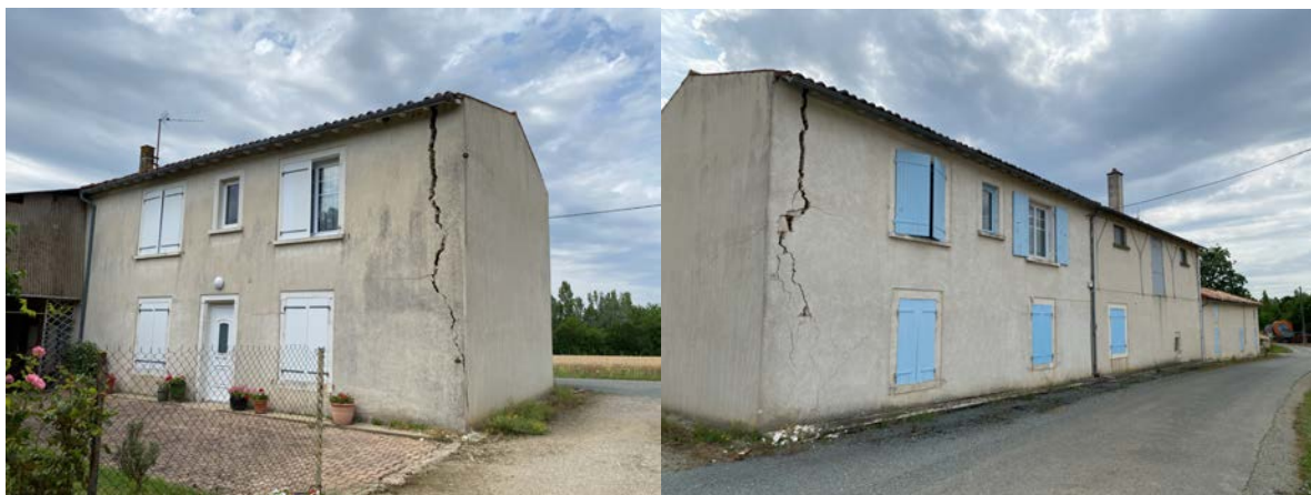
Figure 2-20 : Endommagement de degré 3, perte de continuité entre les murs extérieurs, la partie droite du bâtiment ne semble pas avoir subi de dégâts aussi sérieux (commune de La Laigne, lieu-dit Le Moulin), vues avant et arrière du bâtiment.
