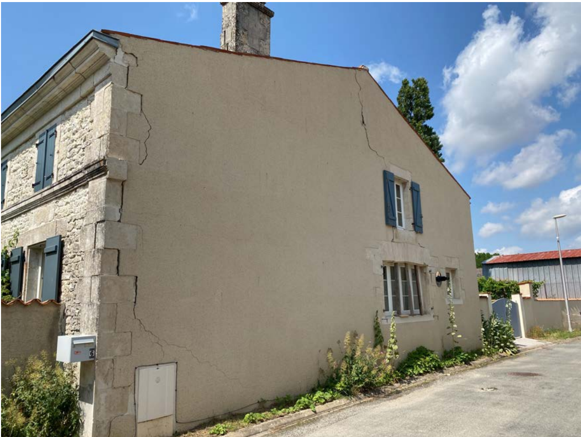
Figure 2-32 : Fissuration le long du harpage d'angle en maçonnerie de pierres massives sur un bâtiment en maçonnerie de pierres, dommage de degré 3 (commune de Cram-Chaban – lieu dit Le Peu).
