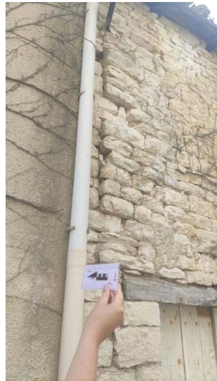
Figure 2-34 : Interaction entre deux bâtiments, et début de poussée hors plan de pierres taillées, (commune de Cram-Chaban).
