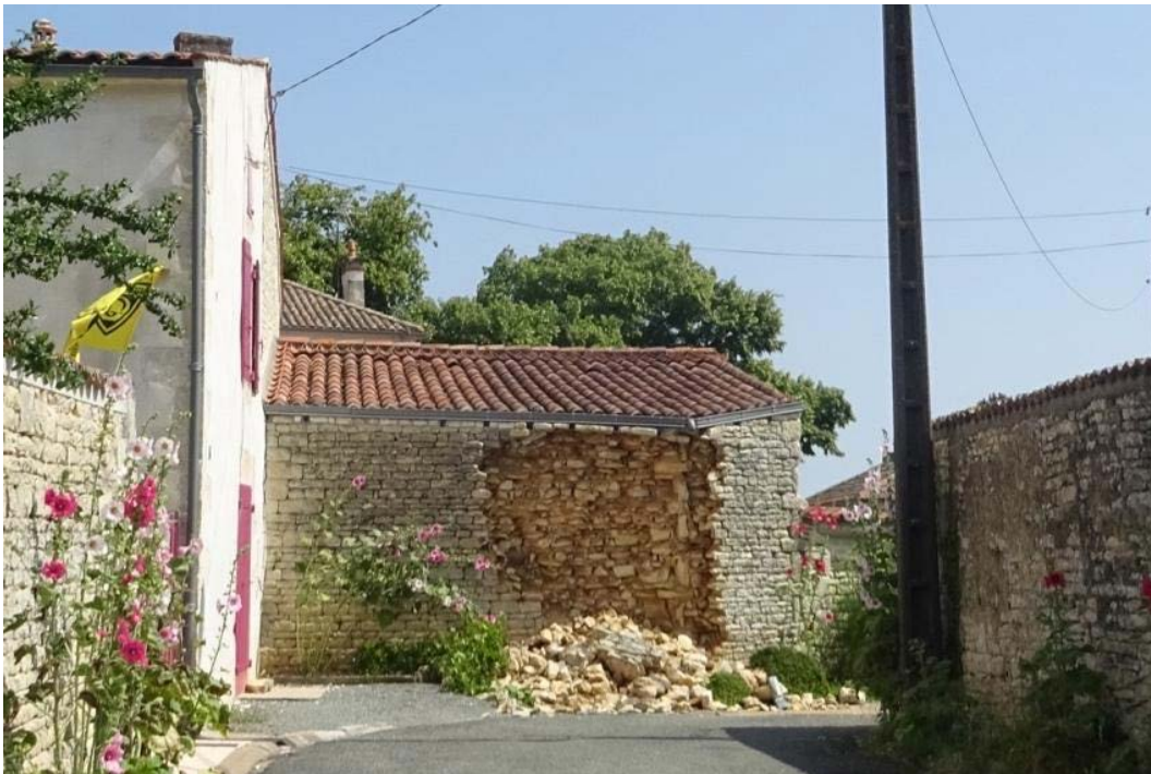
Figure 2-16 : Dommages de degré 4, défaillance sérieuse d'un mur en maçonnerie de pierres (commune de La Laigne).
