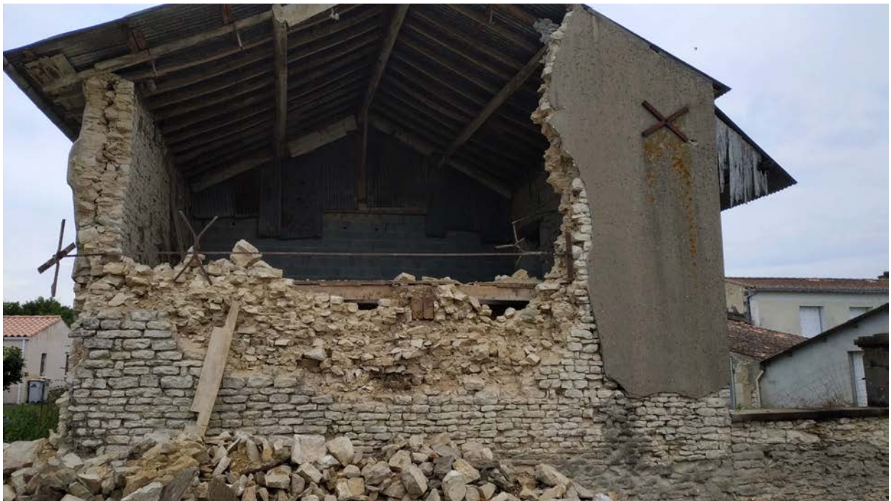
Figure 2-27 : Dommages de degré 4 , dislocation hors plan d'un mur porteur sur une grange en maçonnerie de pierres, la partie de gauche au droit de la planche verticale a été effondrée par les pompiers pour raison de sécurité (commune de Cram-Chaban)
