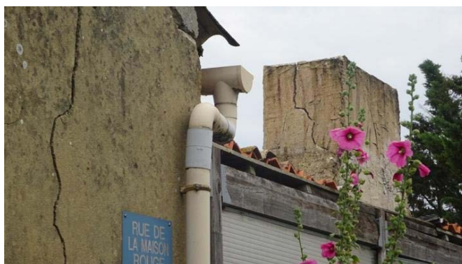
Figure 2-24 : Exemple d'endommagement de cheminée (commune de Cram-Chaban)
