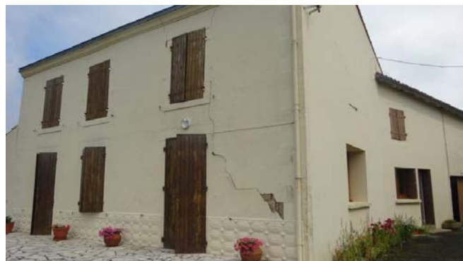
Figure 2-25 : Endommagements de degré 2, fissuration diagonale sur maçonnerie de pierres (commune de Cram-Chaban)
