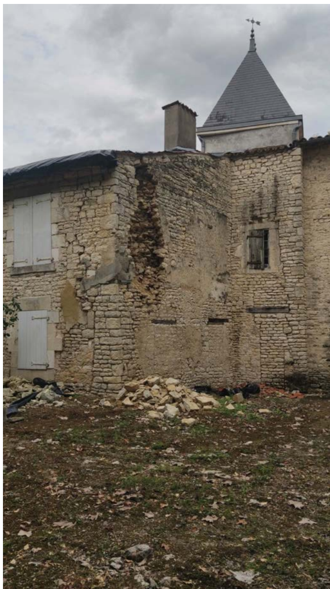
Figure 2-21 : Dommage de degré 4, dislocation hors plan du parement en pierres taillées d'un bâtiment en maçonnerie de pierres, irrégulier en plan, perte de continuité de la maçonnerie et endommagement des fermes de toitures (commune de La Laigne, lieu-dit BeauLieu)
