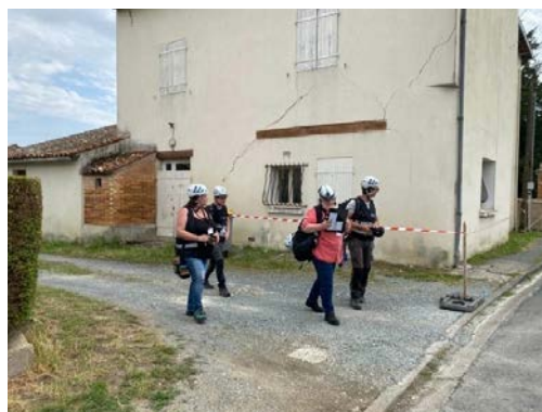
Figure 2-10 : Fissuration diagonale, endommagement de degré 2 et équipe d'experts du GIM (commune de La Laigne).
