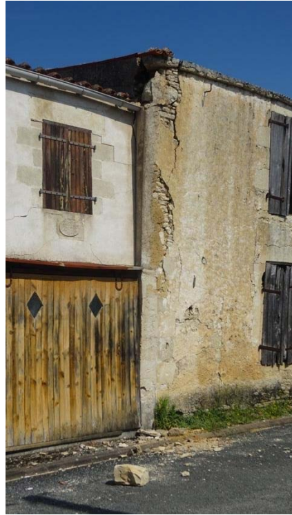
Figure 2-15 : Dommages de degré 3, fissuration large en angle de bâtiment et poussée hors plan d'éléments de maçonneries de pierres, interaction entre deux bâtiments (commune de La Laigne).
