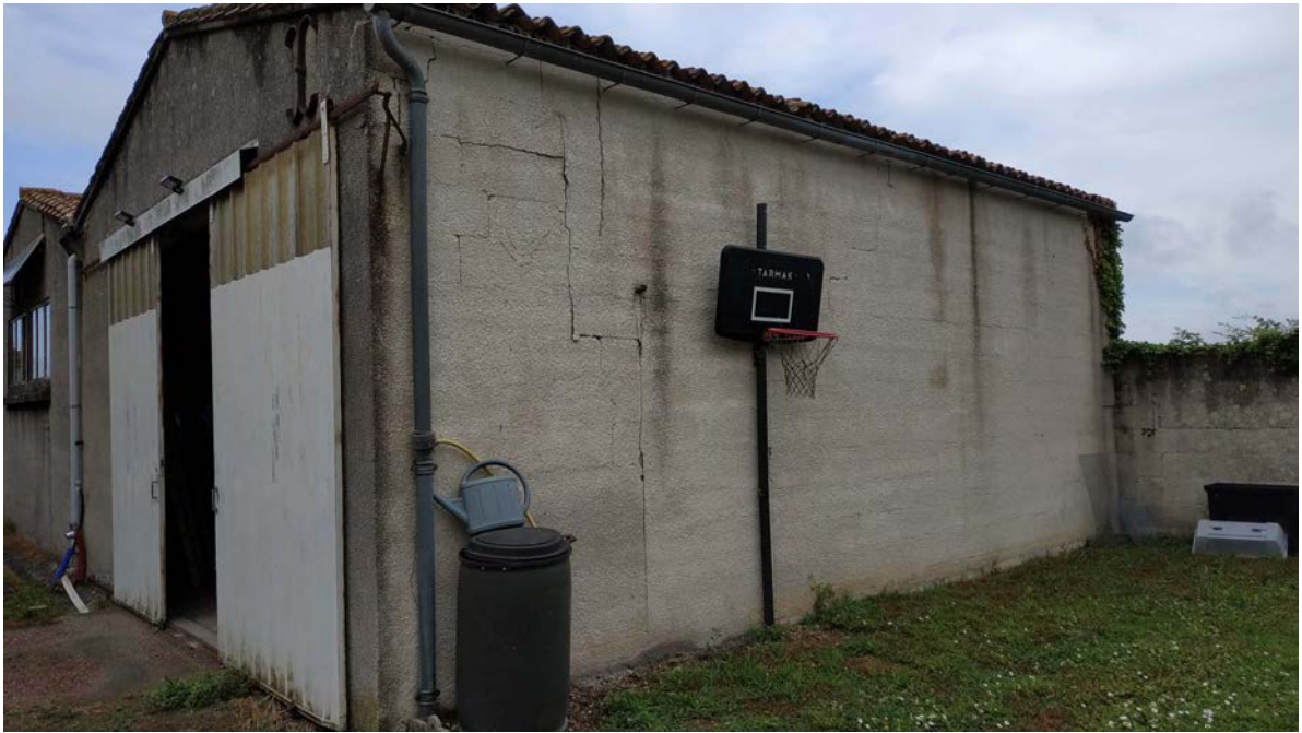
Figure 2-36 : Endommagement de degré 2, fissuration entre les éléments préfabriqués de béton (agglos), (commune de Cram-Chaban).
