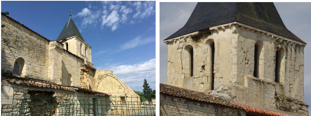
Figure 2-12 : Endommagement sérieux de la nef et du clocher de l'église en maçonneries de pierres, présentant des fissures en cisaillement et un endommagement hors plan au droit des fermes de toiture au-dessus des voûtes des ouvertures (commune de La Laigne).
