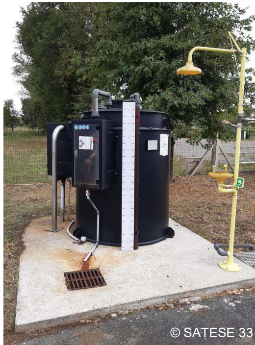
Figure 20 : Stockage du chlorure ferrique en cuve
