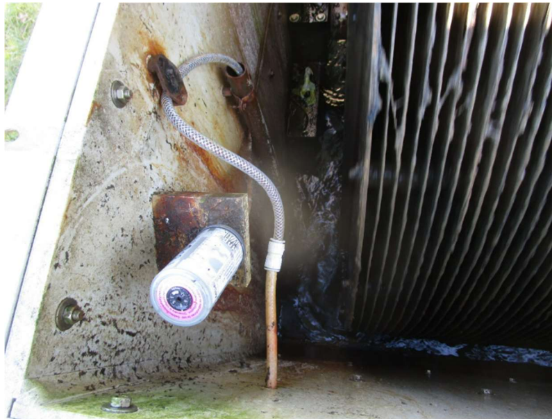
Figure 11 : Injection du chlorure ferrique directement dans le réacteur des disques biologiques : à proscrire !
