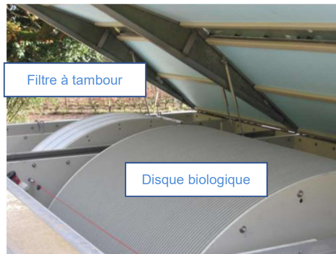
Figure 12 : Combinaison d'un disque biologique et d'un filtre à tambour au sein d'un même ouvrage (station neuve) : à éviter au regard des contraintes lourdes d'exploitation
