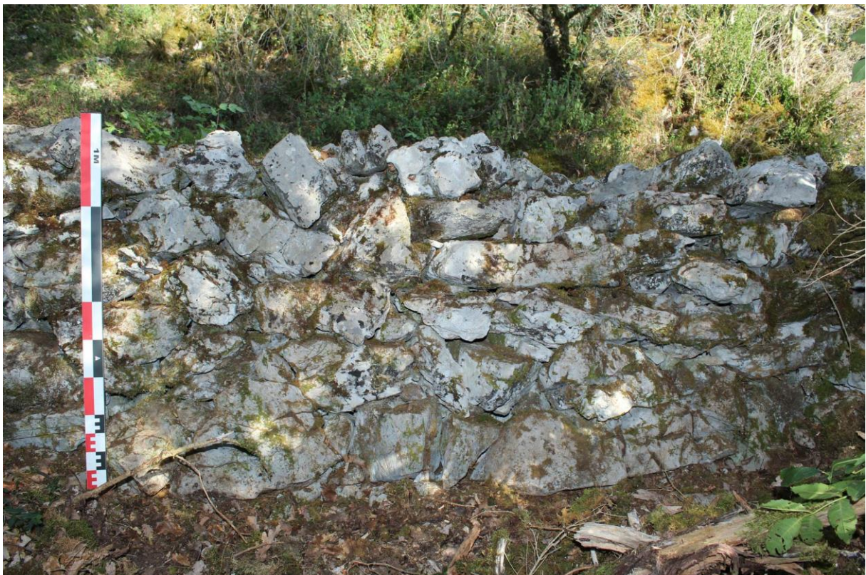
Fig. 10. Le chemin ancien au nord-ouest du site : détail de mur de soutènement construit en pierres sèches et assis sur le socle rocheux (premier segment linéaire du chemin).
