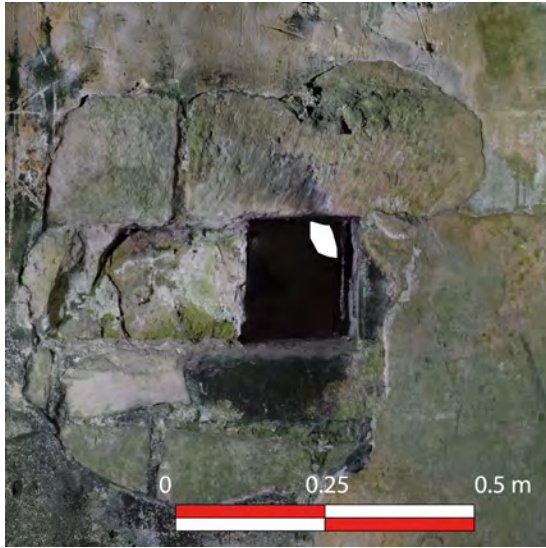
FIG. 53 : Vue de détail d'un des trous de boulin, l'UC53. Certains des trous de boulin semblent originellement recouvert par l'enduit UC44 (Aaron Gatt).
