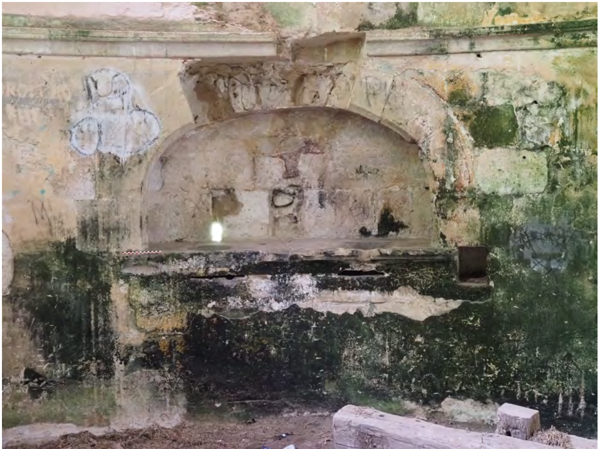
FIG. 52 : Photographie de détail du renforcement (UC58) avec les deux bassins liturgiques. La voûte (UC98) est grandement endommagée (Mathias Bellat).
