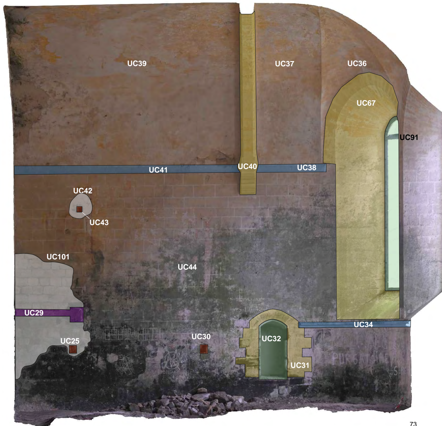
FIG. 62 : Orthophotographie avec découpage stratigraphique de la façade intérieure nord du chœur de la chapelle prise depuis le sud (Photogrammétrie cabinet Bortolussi; D.A.O. Anaëlle Genneret).
