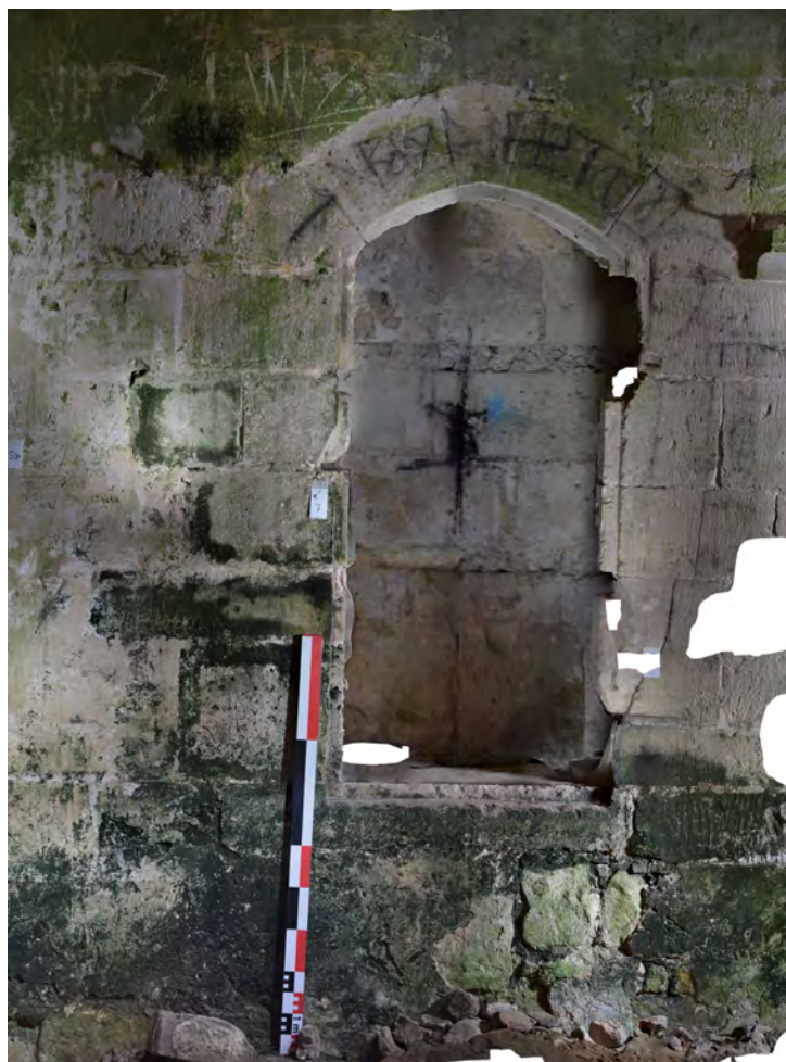
FIG. 60 : Vue de détail de l'armoire liturgique dans le mur nord du chevet. On distingue le creusement, l'UC32, de l'armoire qui accueillait probablement des planche pour stocker le nécessaire aux services religieux et son entablement en pierre l'UC31 qui est distinct du reste de l'enduit l'UC44 (Aaron Gatt).
