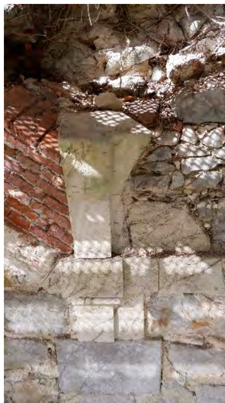
FIG. 48 : Vue de détail de la corniche adossée de l'UC18 et son appareillage fait de pierre de calcaire et briques (Anaëlle Genneret).
