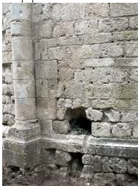
FIG. 44 : Vue de détail du chevet, UC3, depuis l'est avec la destruction de l'US87 (Kévin Warau).
