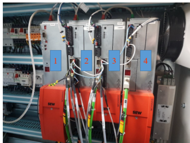
FIGURE 4.8 – Variateurs alimentants moteurs électrique
