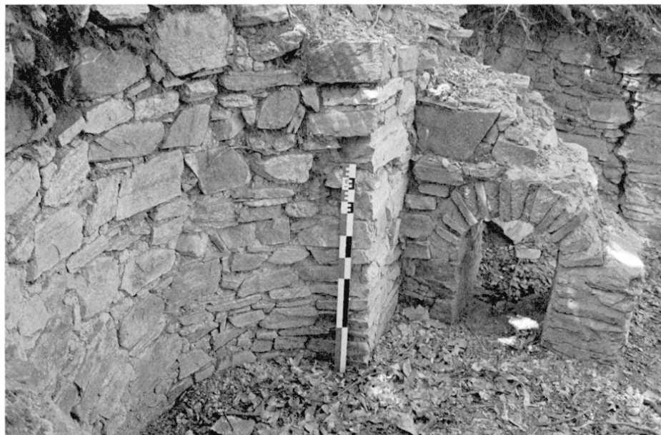
Fig. 3 : Ambarın Düzü, structure maçonnée, vue vers le Nord du mur nord-sud, de l'arc nord et du mur est-ouest fissuré.
