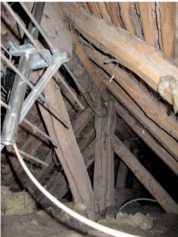
Figure 109. Détail de la charpente dans la partie non accessible des combles. Cliché J.-Ph. Chimier, 2016.
