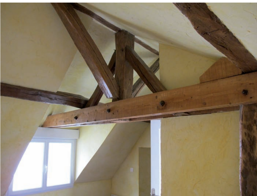
Figure 100. DE 5223. Détail de la charpente et de la lucarne. Cliché J.-Ph. Chimier, 2016.
