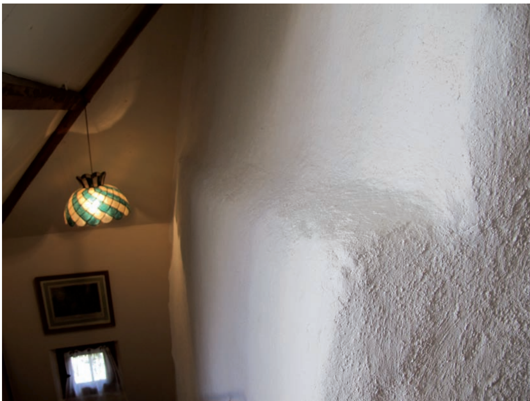
Figure 142. DE 5310. Vestiges de l'appui de l'escalier extérieur sur le face nord du pignon nord. Cliché J.-Ph. Chimier, 2016.
