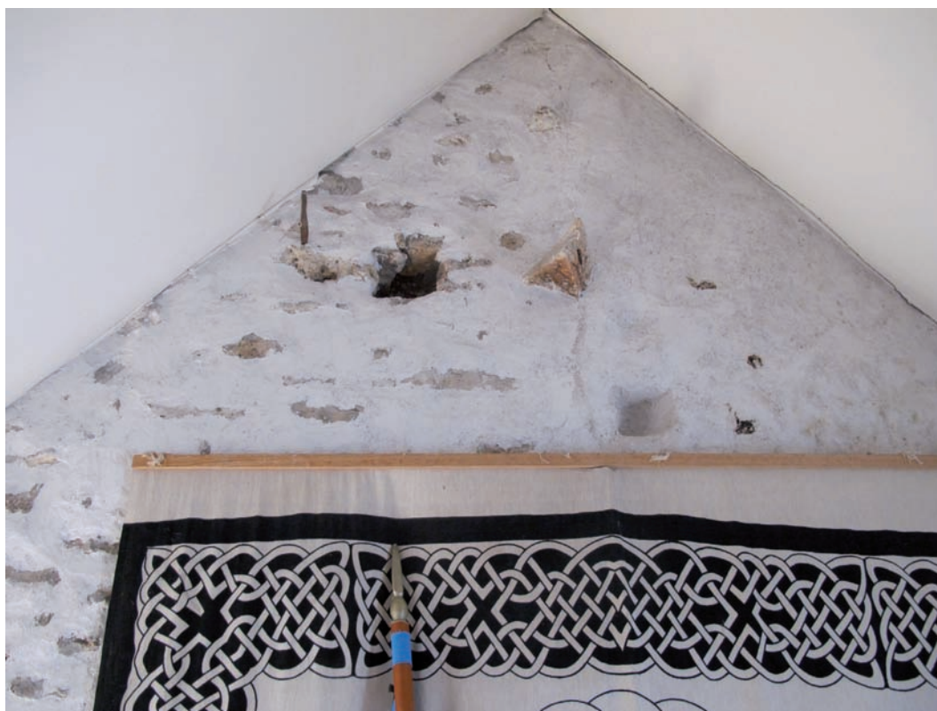
Figure 153. DE 5318. Traces d'arrachage du coffre de conduit de cheminée. Cliché J.-Ph. Chimier, 2016.
