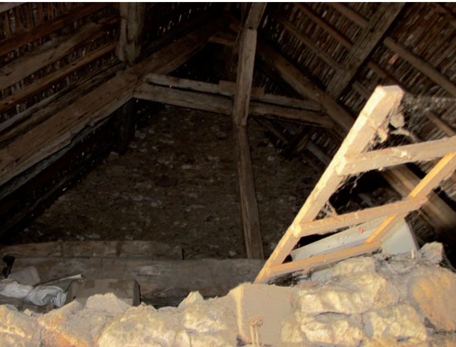
Figure 95. DE 5224. Vue de la charpente et du mur pignon sud en arrière plan. Chimier, 2016.
