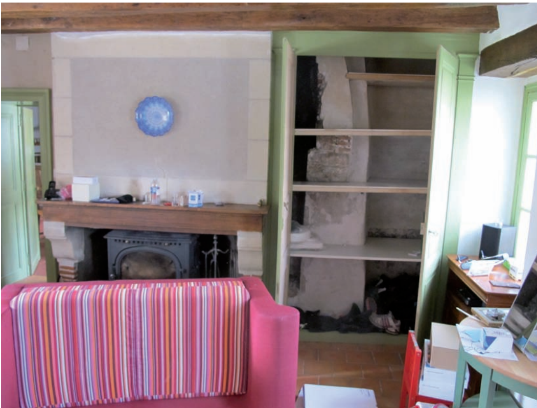
Figure 106. Détail de la cheminée actuelle sur le pignon nord et de la console de son état initial dans le placard. Cliché J.-Ph. Chimier, 2016.
