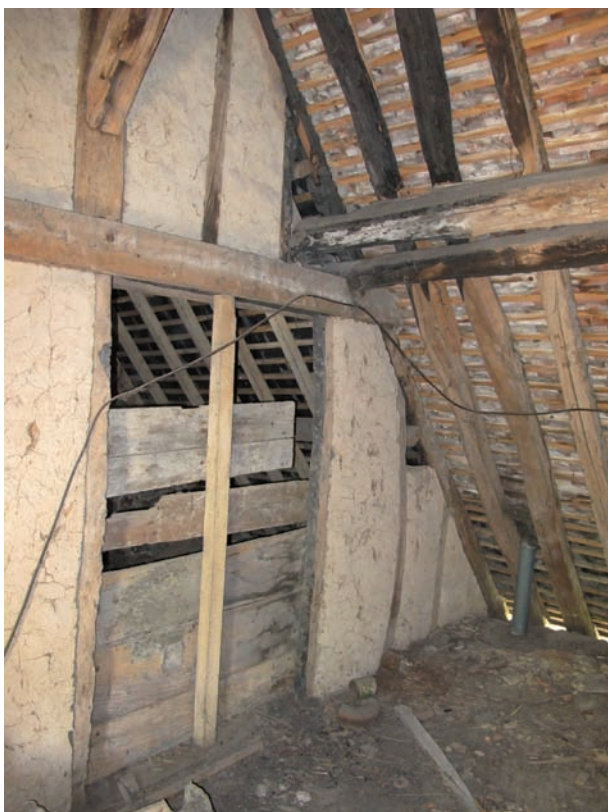
Figure 83. DE 5218. La cloison en pans de bois qui sépare les combles de 5218 et 5219, détail des parties brûlées de la charpente. Cliché J.-Ph. Chimier, 2016.
