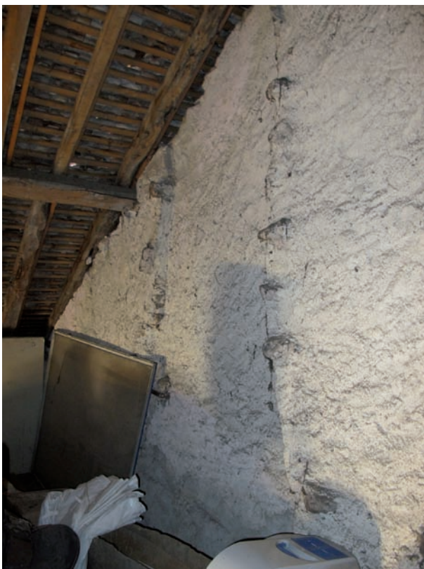
Figure 127. DE 5208. Traces d'arrache du coffre du conduit sur le pignon. Cliché J.-Ph. Chimier, 2016.
