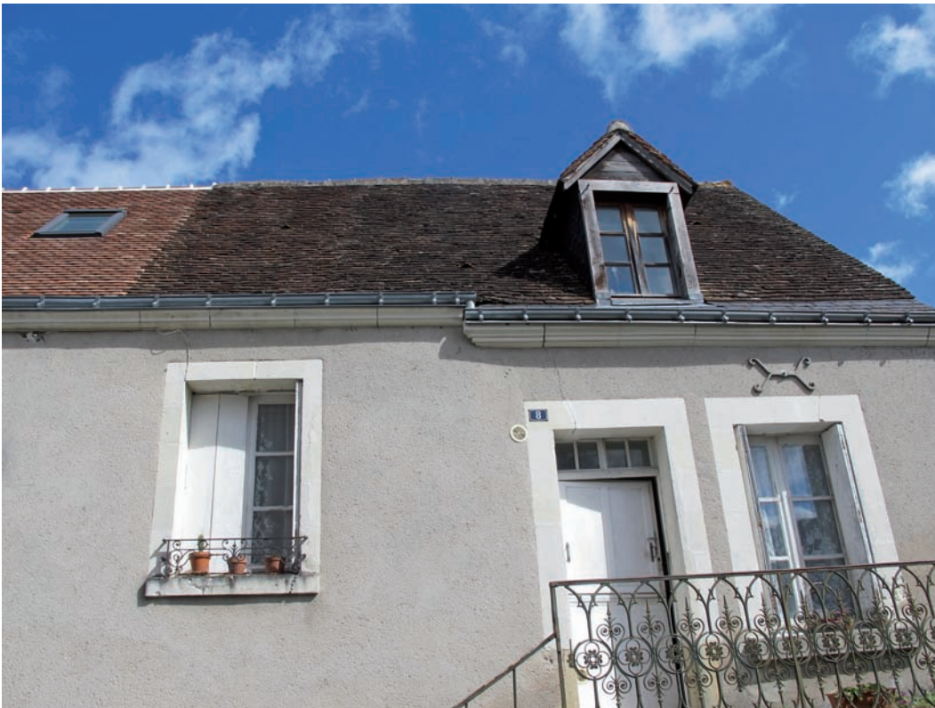
Figure 152. DE 5318. Rupture dans la toiture à l'emplacement du pignon intermédiaire. Cliché J.-Ph. Chimier, 2016.
