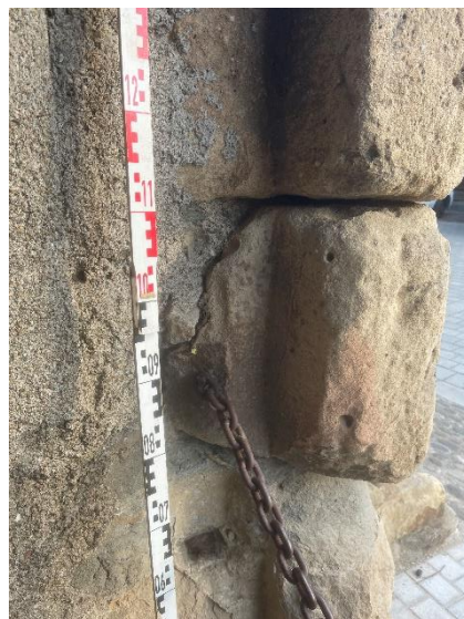
Fig. Usure à l'arrière du piédroit.
