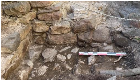
Fig. Absence de chaînage entre le mur Us 1-3 (Uc7) et le mur ouest (Uc14)
