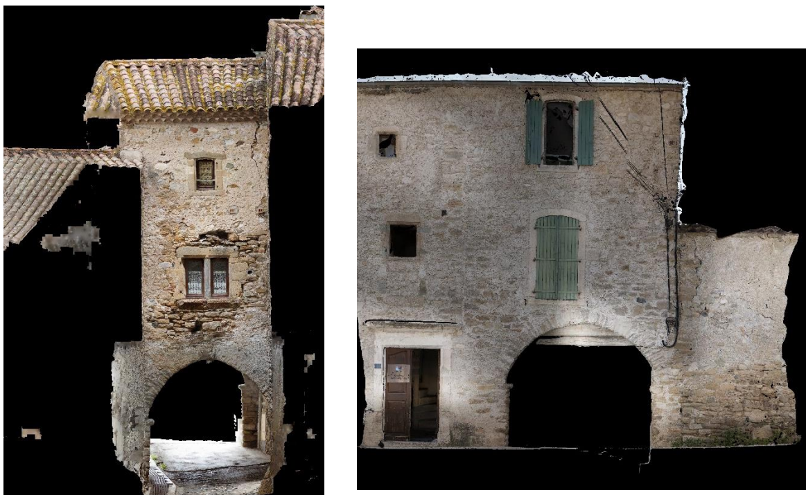
Fig. Entrée sud (gauche) et nord (droite) du passage couvert. Crédit Emmanuel Garcia (Le Chantier Lumineux) et Pascal-Robert-Cols (ACCA).
